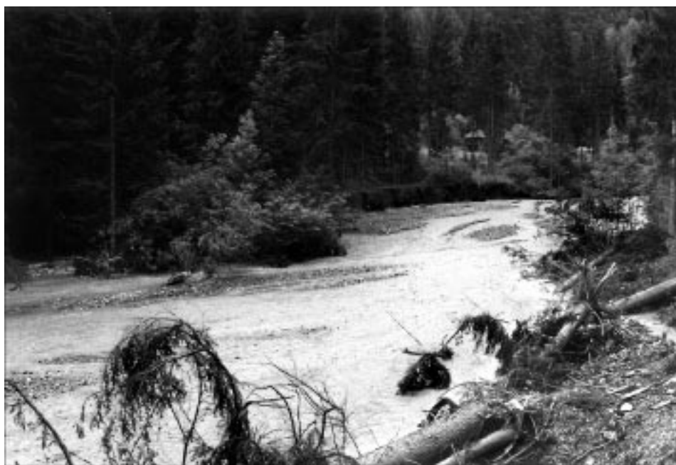
Abb. 11. Retentionsbecken nach dem Hochwasserereignis.
