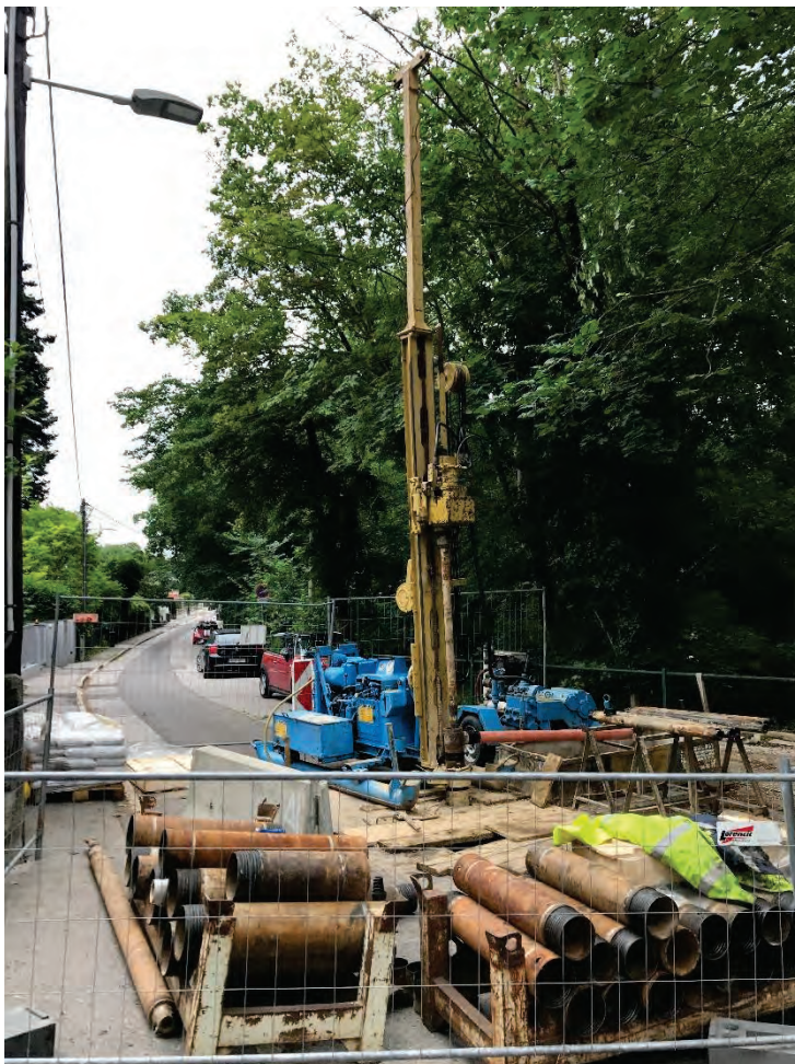
Probebohrung nach einem Erdfall unter einer Straße
