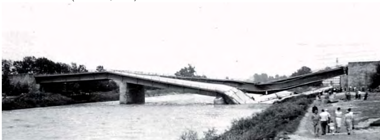
Abb. 4: Salzachbrücke der Westautobahn A 1 nahe Hagenau (Gemeinde Bergheim), beim Hochwasserereignis am 13. August 1959 infolge Unterspülung des östlichen Brückpfeilers (im Bild rechts) eingestürzt. Blickrichtung NNW (Quelle: Bildarchiv Oberst i.R. Dr. Koppensteiner).
