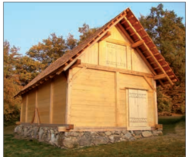
Abb. 11: In den Sommermonaten 2018 wurde im Freilichtmuseum am Burgberg ein neues Architekturmodell in Schwellenbautechnik auf einem Fundament aus Trockensteinmauerwerk errichtet (Foto: W. F. A. Lobisser)
