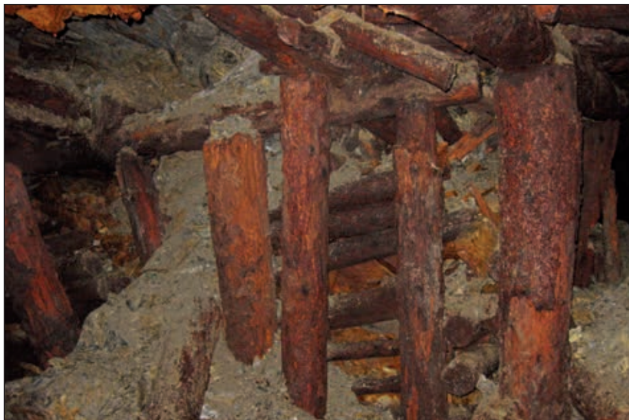
Abb. 17: Rundholzzimmerung aus der Zeit um 1930 mit Verbruch im „Theresienstollen“. (Foto: Ing. Peter Weißnar, 2014.)
