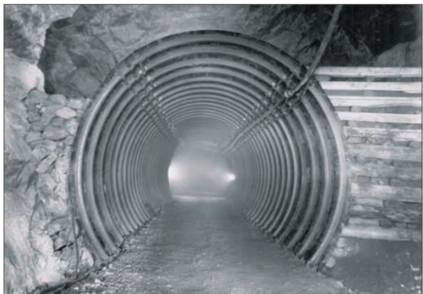
Abb. 12: Ringzimmerung Revier IV. Überbauen der Schrägstrecke Revier IV – V im Jahre 1977. Der Einbau einer Stahlringzimmerung im Versatz des Revieres IV West erhält den Zugang zur Ausrichtungsstrecke für die tieferen Lagerstättenteile.
