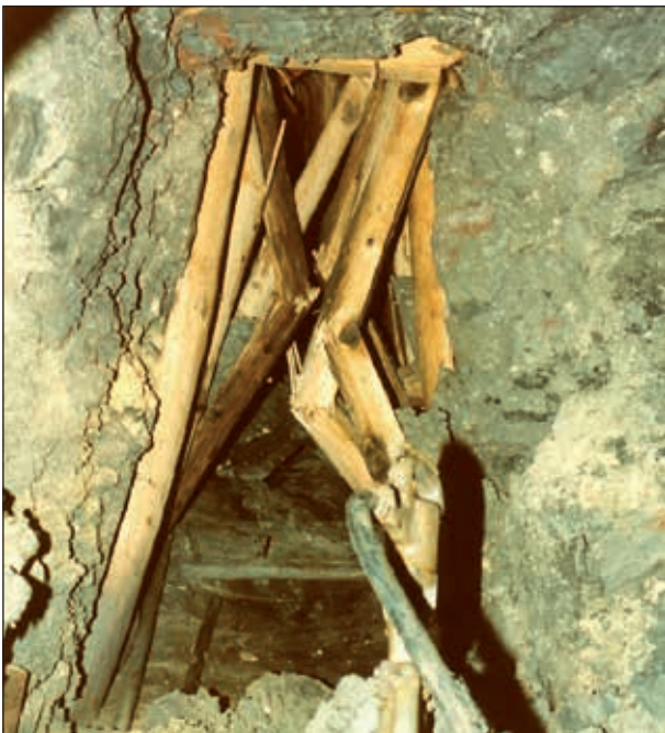
Abb. 19: Vom Gebirgsdruck zerstörter Ausbau
