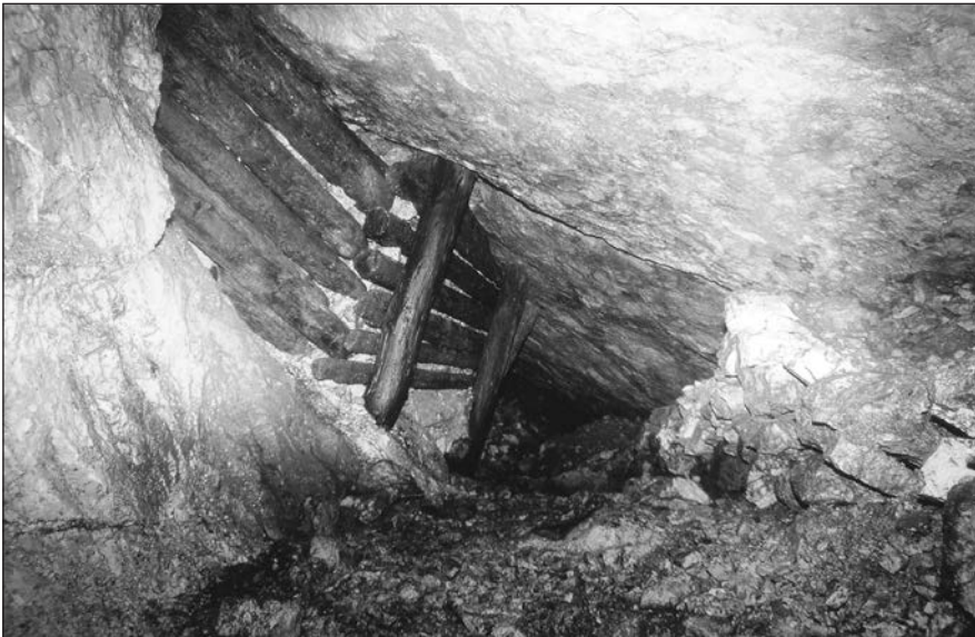
Abb. 4: Abbaue auf dem Grafengang (abgebaut um 1870), Grafenstollen, Teilrevier Rotenstein, Bergbau Ringenwechsel, Foto Hanneberg.
