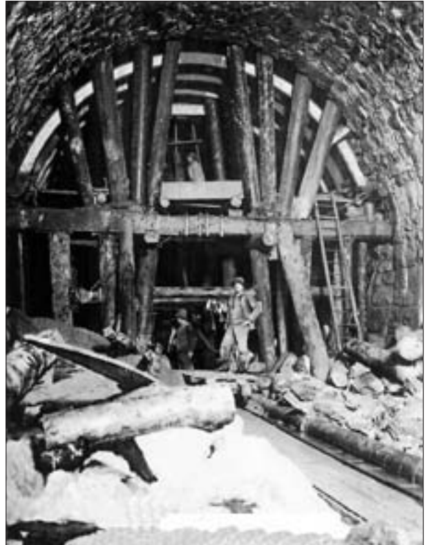
Abb. 1: Bau des Tauerntunnels zwischen Böckstein und Mallnitz der Eisenbahnstrecke Schwarzach – Spittal a. d. Drau (Tauernbahn), Aufnahme ca. 1905.
