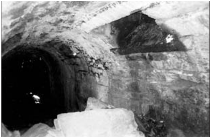
Abb. 3: Abzugsstollen (Sohlstollen) mit Füllschnauze (rechts) im Barbara-Erzkasten. Aufnahme: H. J. Köstler, Mai 1999.
