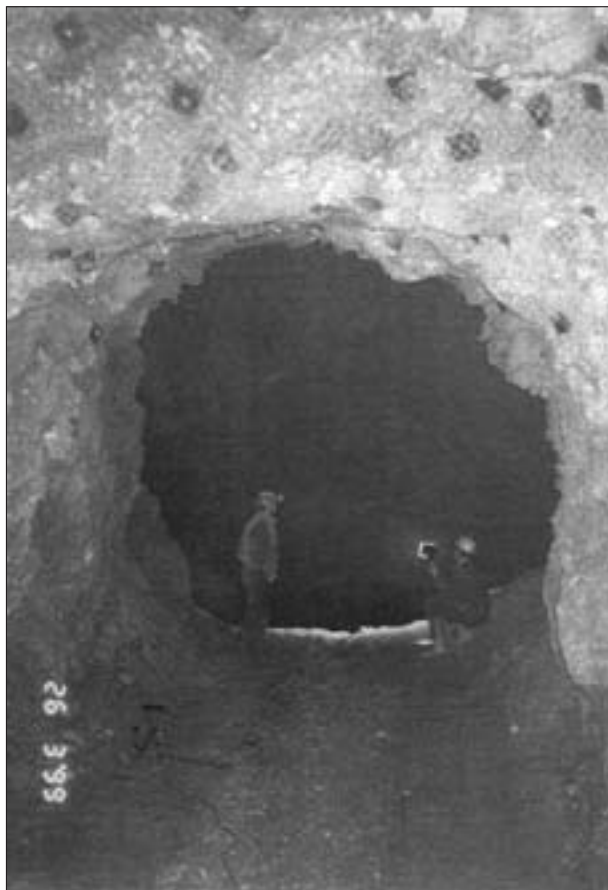
Abb. 7: Löcherung Abbauhohlraum Fuggertal
