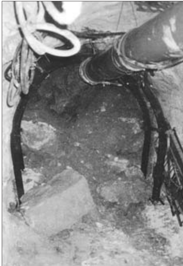
Abb. 6: Verbruch im Hl. Geist-Unterbaustollen
