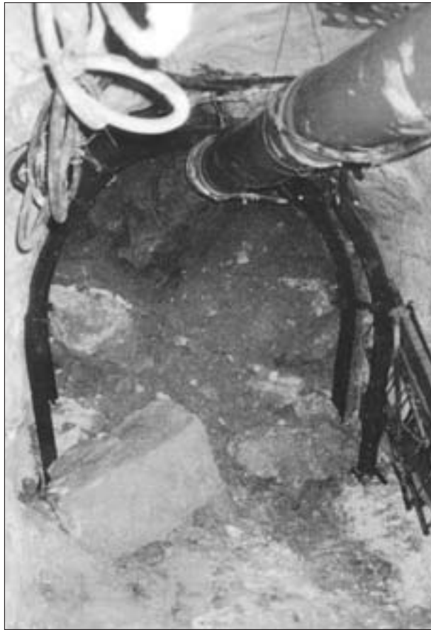
Abb. 6: Verbruch im Hl. Geist-Unterbaustollen
