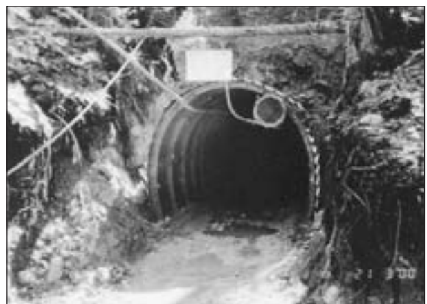
Abb. 5: Luftbogenstrecke Hl. Geist-Unterbaustollen
