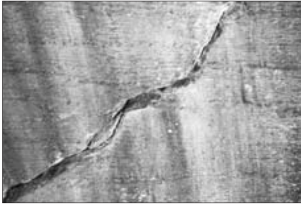
Abb. 29: Wand 3. Spalte; klaffende Fuge. Foto R. Konopasek, Oktober 2004.
