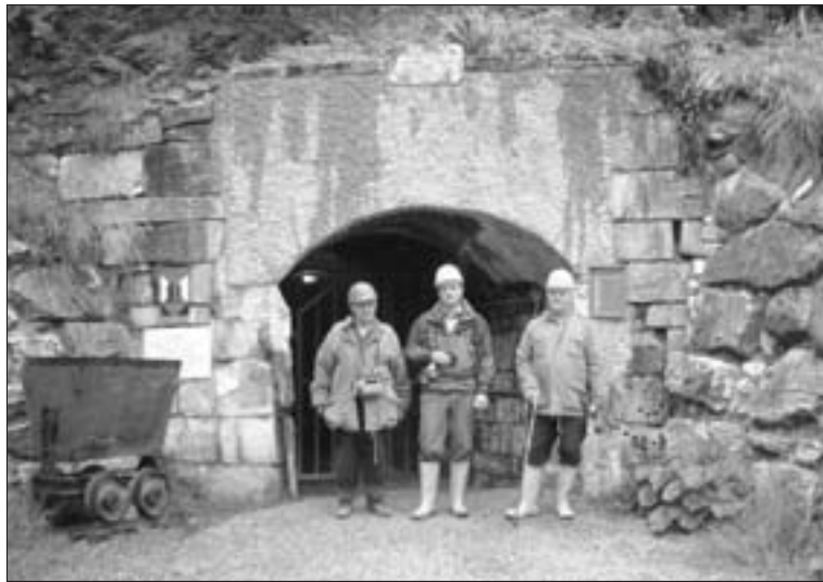
Abb. 7: Das wiedererrichtete Portal des Thaddäusstollens nach erfolgter Sicherheits- und Sanierungstätigkeit (Foto Karl Herbert Kassl 04. 07. 2003).
