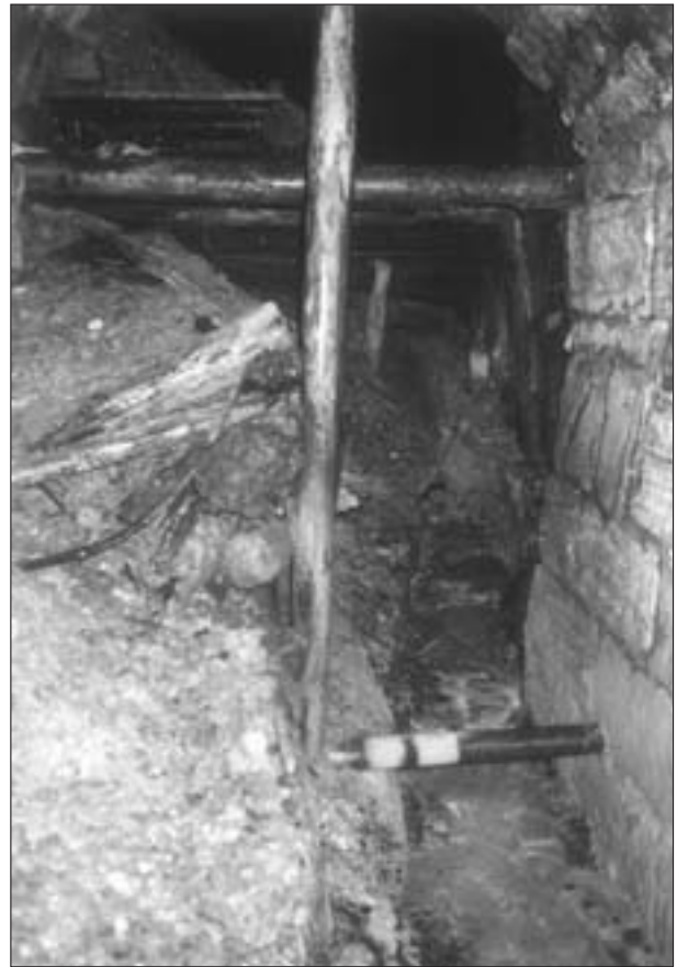
Abb. 5: Die ersten Stollenmeter des teilverbrochenen Thaddäusstollens 1997: Der freie Wasserabfluss musste gewährleistet bleiben (Foto Karl Herbert Kasl 26. 07. 1997).
