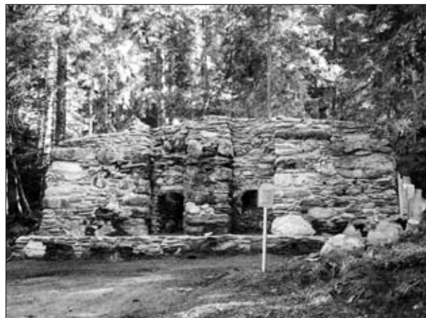
Abb. 2: „Schwefelofen“ in der Walchen nach Freilegung und Restaurierung der Frontmauer mit zwei Schwefelfängen (vgl. Abb. 3). Aufnahme: H. J. Köstler, Sept. 2003.
