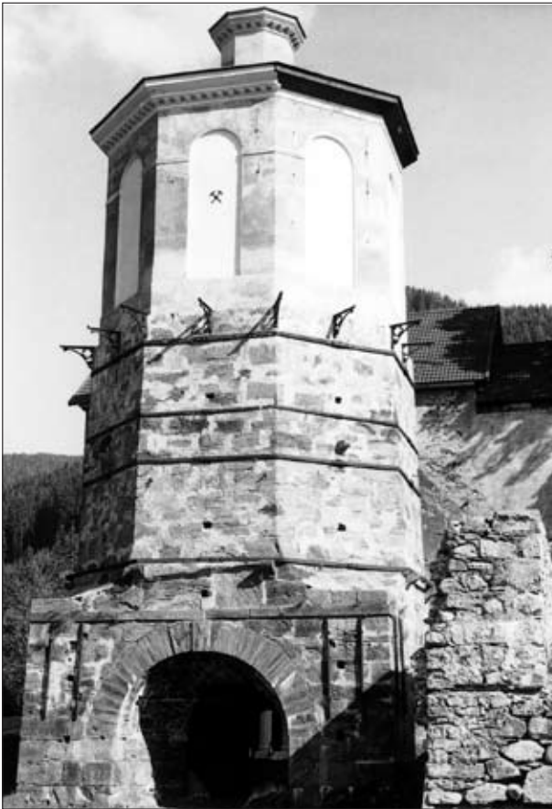
Abb. 18: Hochofen der „Franzenshütte“ in Bundschuh. Ofensockel mit Abstichgewölbe, darüber Rauhgemäuer mit Rauchhaube, dazwischen Konsolen des noch nicht restaurierten Fluchtbalkons. Aufnahme: H. J. Köstler, Juni 1984
