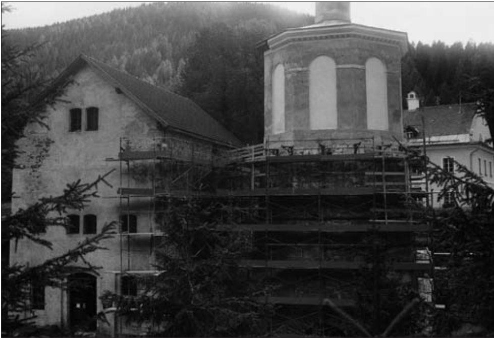
Abb. 48: Restaurierung des Hochofens der „Franzeshütte“; links: Gebläsehaus (Museumsräume), rechts hinten: Forsthaus. Aufnahme: J. Heiß, 1994
