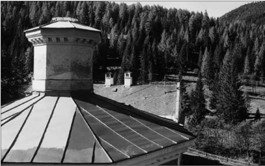
Abb. 50: Dach der Rauchhaube mit Kamin auf dem Bundschuher Hochofen. Aufnahme: J. Heiß, 1994
