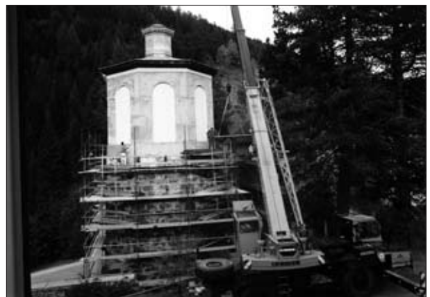
Abb. 47: Restaurierung des Hochofens der „Franzeshütte“ in Bundschuh; „Großbaustelle“ im Rahmen der Generalsanierung 1994. Aufnahme: J. Heiß
