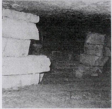
Abb. 3: Abstützung der Firste durch Gesteinsschichtung (Foto Friedrich Almer, Waidhofen an der Ybbs)
