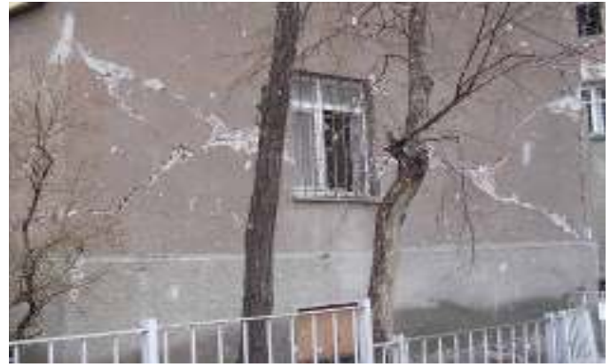
(d) Stepped shear cracking (Source: A. Turer)
