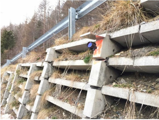
Abb. 24: Kerschbaumsiedlung – Reflektorprisma für den Autotheodolit
