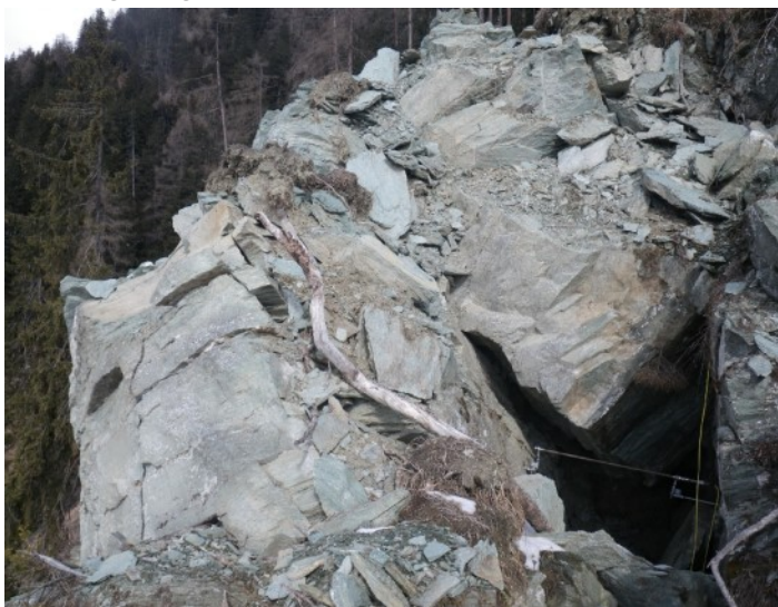
Abb. 39: Ingelsberg – installiertes Fisurometer
