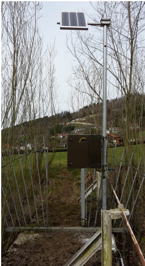
Abb. 81: Reingrubergaben - Datenübertragungsbox und Solarmodul
