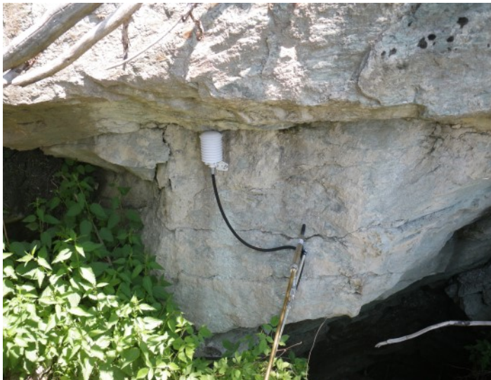
Abb. 38: Ingelsberg – installiertes Fisurometer
