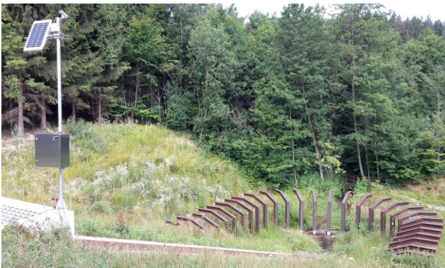
Abb. 83: Trieseneggerbach – Datenübertragungsbox, Kamera und Solarmodul
