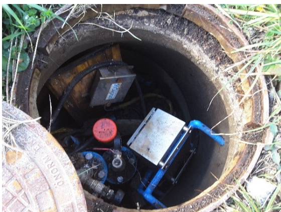
Abb. 22: Sibratsgfäll – Installiertes Inklinometer
