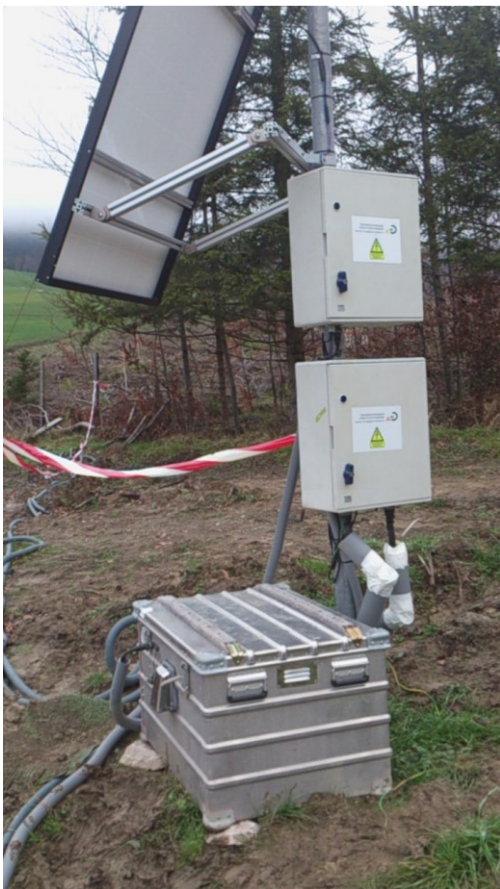
Abb. 48: Pechgraben – geoelektrisches Monitoring
