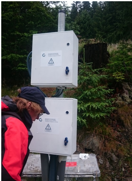
Abb. 26: Kerschbaumsiedlung – Steuerungskästen geoelektrisches Monitoring
