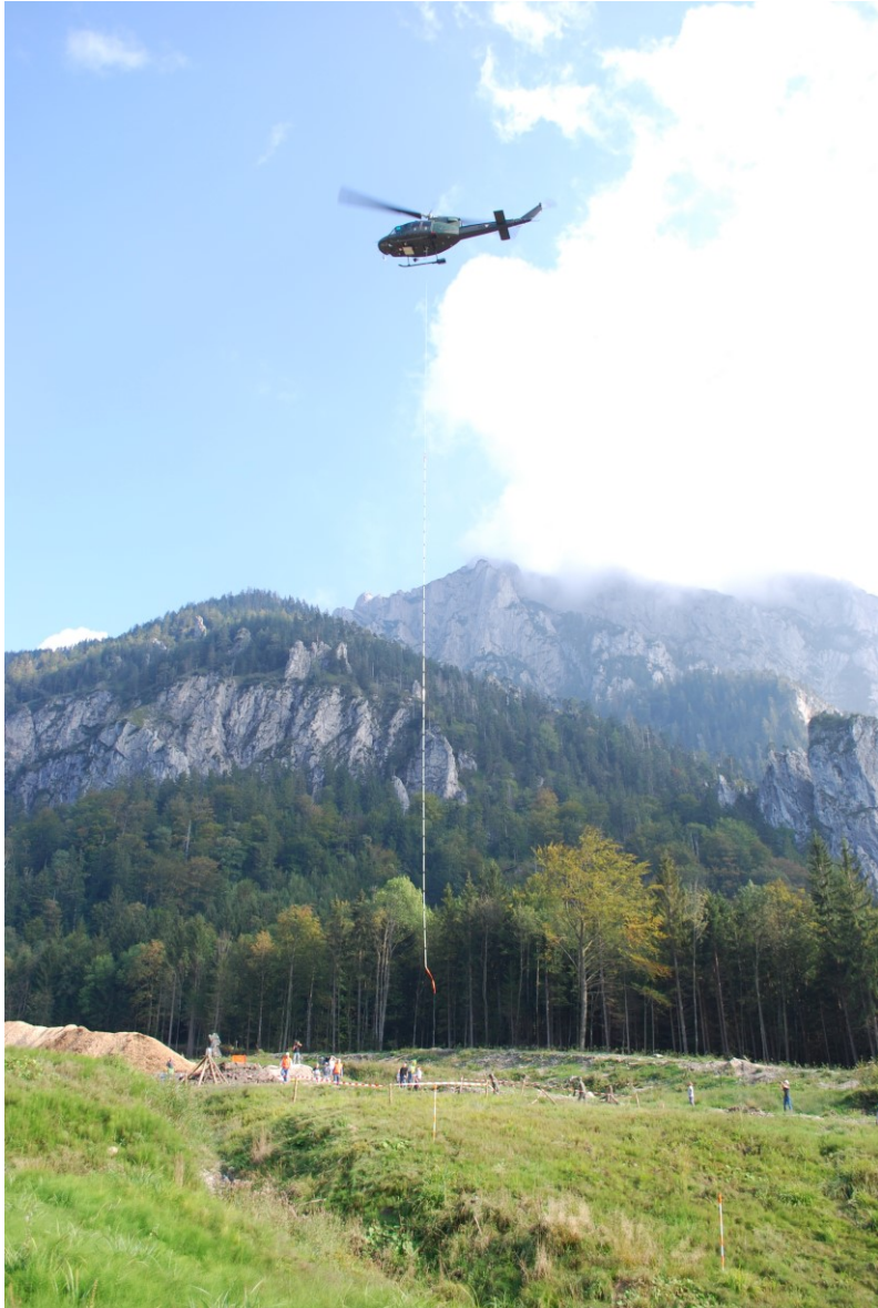
Abb. 45: Gschlifegraben – Inclinometerinstallation im mittleren Bereich des Gschlifegrabens
