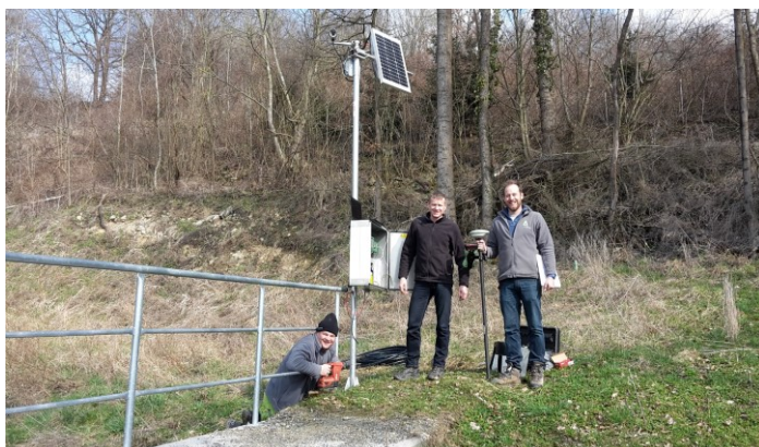
Abb. 72: Autenberggraben – IP-Kamera, Solarmodul und Datenübertragungsbox
