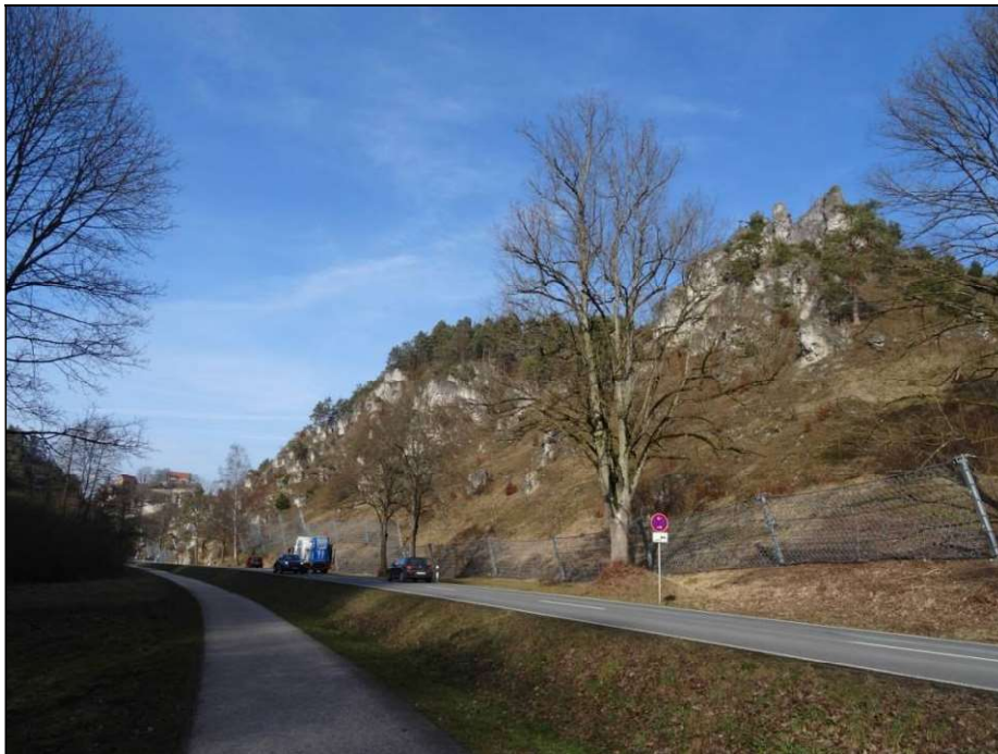
Abb. 8: Südliche Ortszufahrt von Pottenstein mit Steinschlagschutzzäunen
