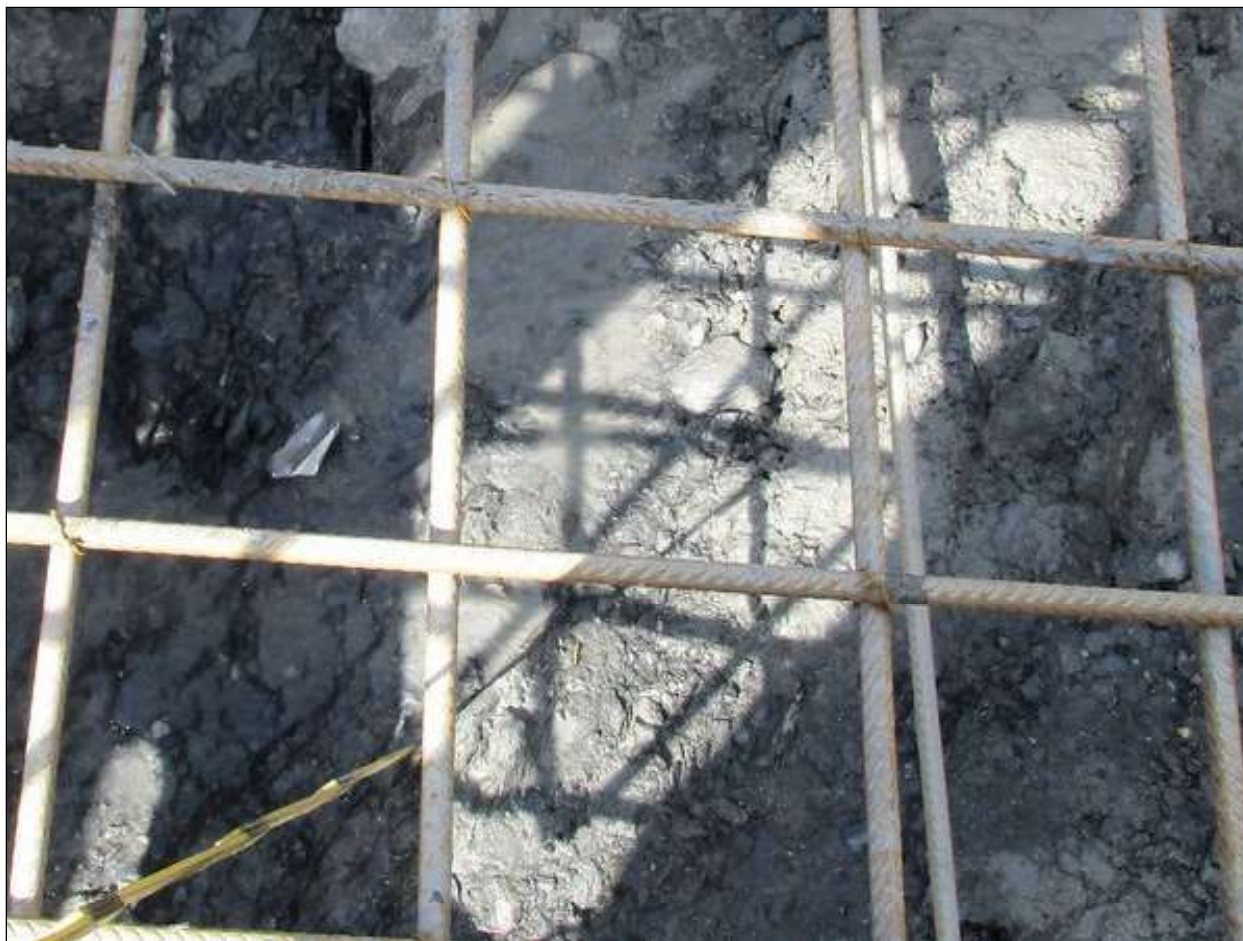
Abb. 7: Wasseraustritte unter Gründungssohle Dichtriegel bei Entnahmebauwerk
