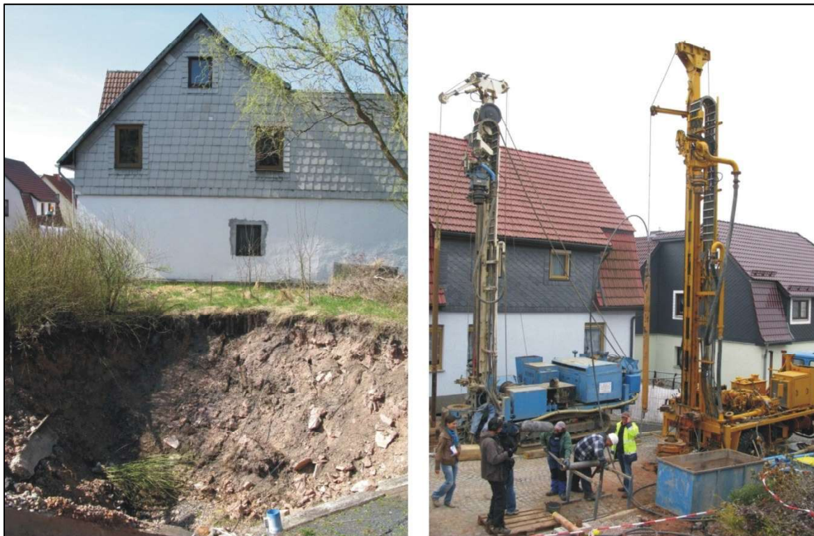
Abb. 1: Der durch den Nachbruch am 28.01.2010 entstandene Erdfalltrichter liegt direkt neben einem Wohnhaus (links). Die dort Anfang November 2010 angesetzten Bohrarbeiten dienen der Erkundung und Errichtung eines Frühwarnsystems (rechts).
