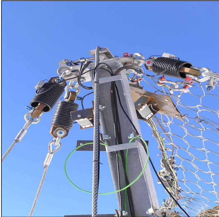
Abb.14: Instrumentiertes Schneenet auf dem Hafelekar zur Ermittlung von auftretenden Kräften.
