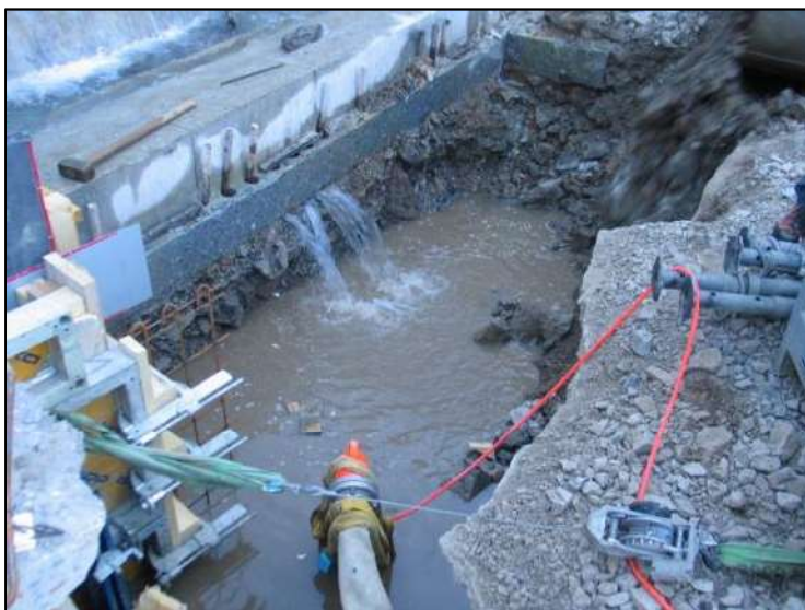
Abbildung 9 und 10: Unterströmung Fundament und Rohrschirm, Quellaustritte
