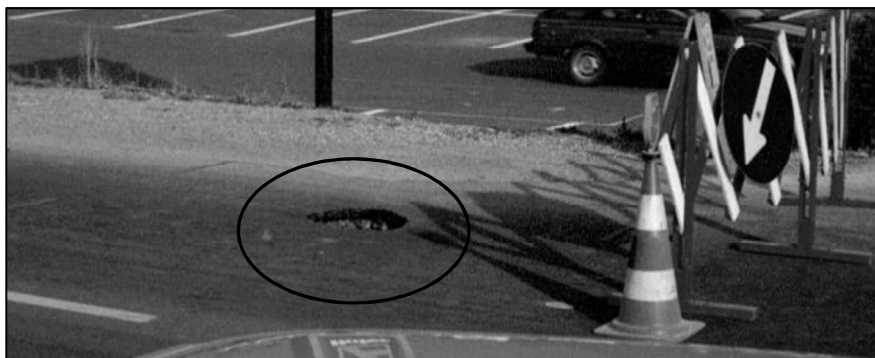
Abb. 4: Erdfall in der Innsbruckerstraße 1986 (Fotos BBA Reutte)
