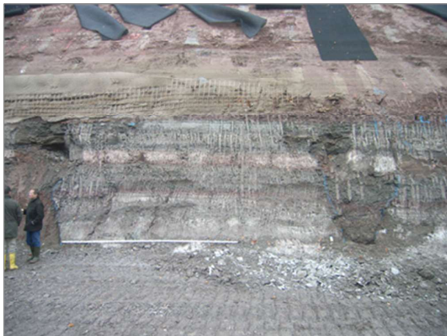
Bild 10: verfüllter Erdfall am Stützbauwerk BAB A38
