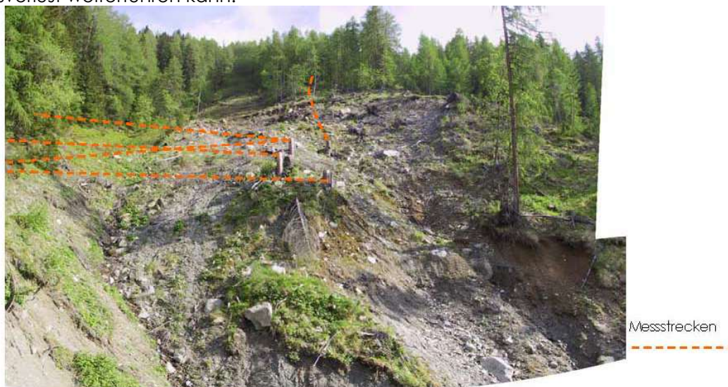
Abbildung 2: Anbruchbereich der „Risselbachmure“ (Bereich 3 in Abbildung 1) aufgenommen im August 2002: Zu erkennen ist das große Spektrum an Korngrößen des Lockermaterials. Der zentrale Buckel stellt eine 1999 noch im Bereich der Rutschung zum Stillstand gekommene Rutschmasse dar. An dieser war von 2002 bis 2004 keine Bewegung relativ zum stabilen Hang links davon festzustellen.
