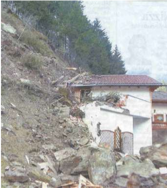
Foto 2: Hangrutschung und Felssturz bedrohen ein Wohnhaus.
