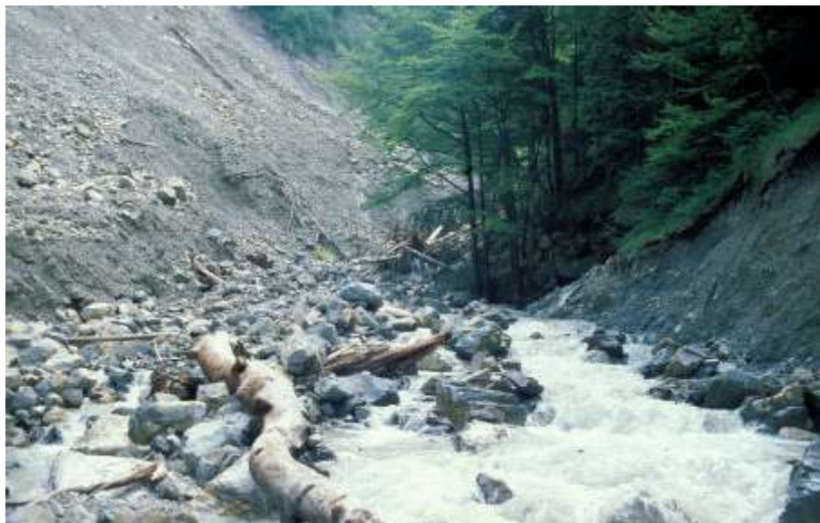
Abb. 7: Der erodierte Damm am Fuß der Rutschung nach dem Pfingsthochwasser 1999.
