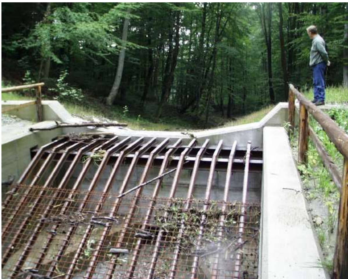
Abb. 6: Rutschung Fürweg Nord: Sammelbauwerk für die Entwässerungsanlage (Aufnahme: Johann Ellmayer)
