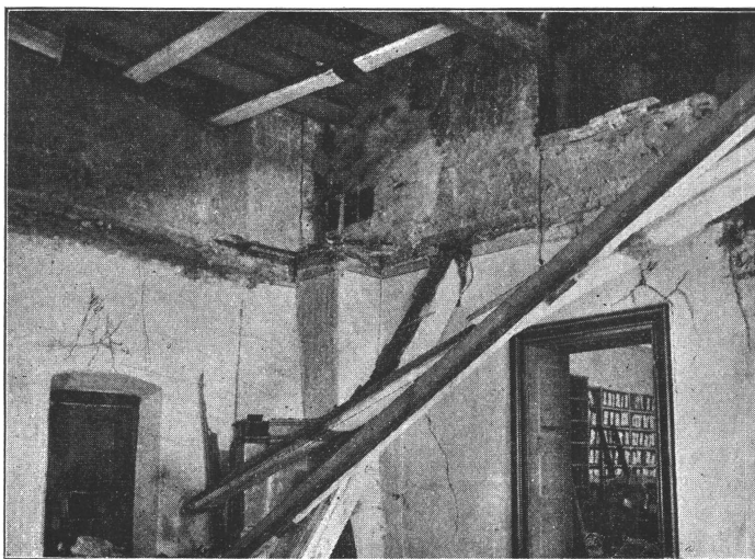
Fig. 7. Durch einen Kaminsturz durchgeschlagene Decke (Wohnzimmer im Fürstenhofe).
