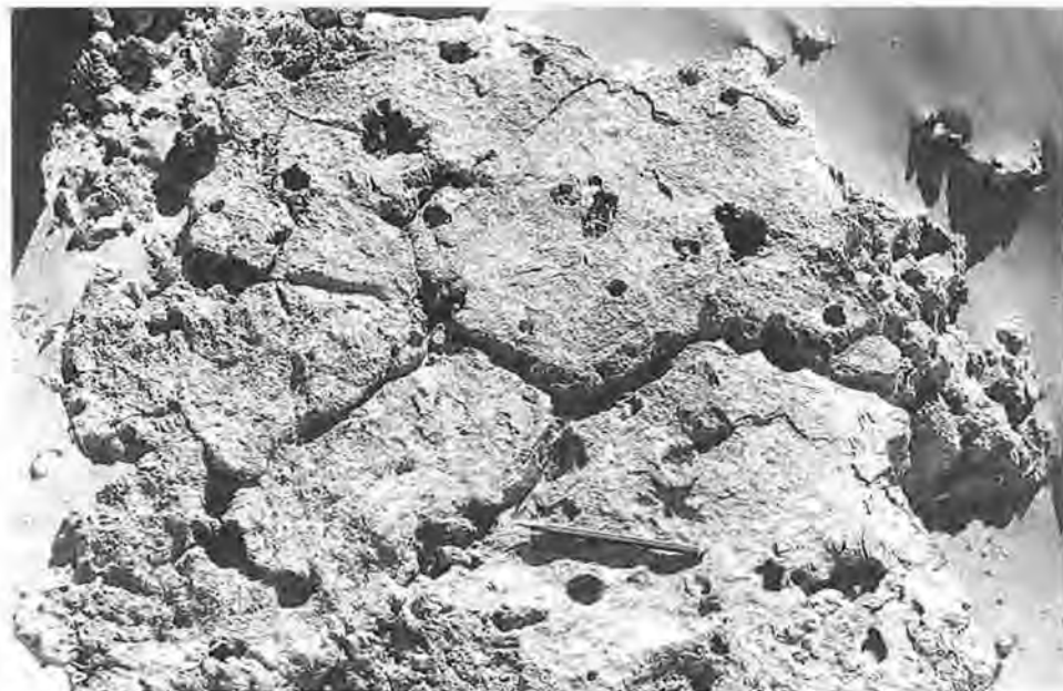
Fig. 4.7: Polygonal zerbrechende und sich auflösende Hartkruste im Bereich der abgespülten miozänen Altfläche. Die kalkkorrosive Verwitterung ist an den verschiedenen Lösungshohlräumen erkennbar. (Foto: H. HÖTZL, 1987.)
