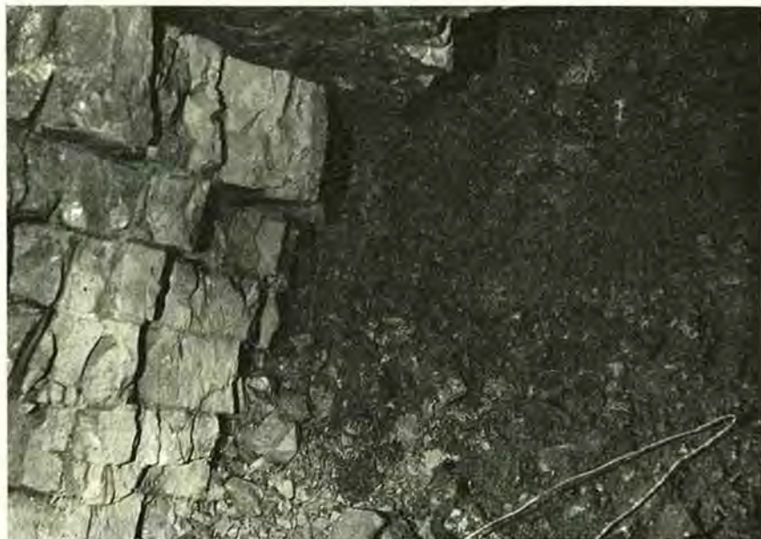
Fig. 9: Donau-Umleitungsstollen. Bruchzone bei 1800 m im Oxfordkalk. Die Schichtung neigt sich gegen die Bruchzone, diese besteht aus einem Haufwerk von korrodierten Kalksteinbrocken und Lehm. Bildbreite etwa 2 m (Foto: A. SCHREINER, 1968).
