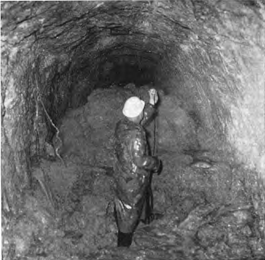
Fig. 8: Schlammereinbruch bei Stollenmeter 4497 des Nordtrums (19. bis 21. April 1967). Foto: Wiener Wasserwerke, 1967.
