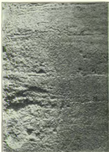
Fig. 1. Sandsteinverwitterung am Kölner Dom.
