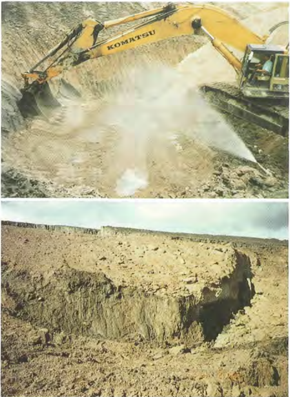
Abb. 5: Anwendung der WSF-Aschen zur Abstützung und Befestigung eines Rutschungsbereiches des Braunkohletagbaues Barbara
