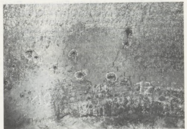
Abb. 9 Lochbildung im Mauerwerk
