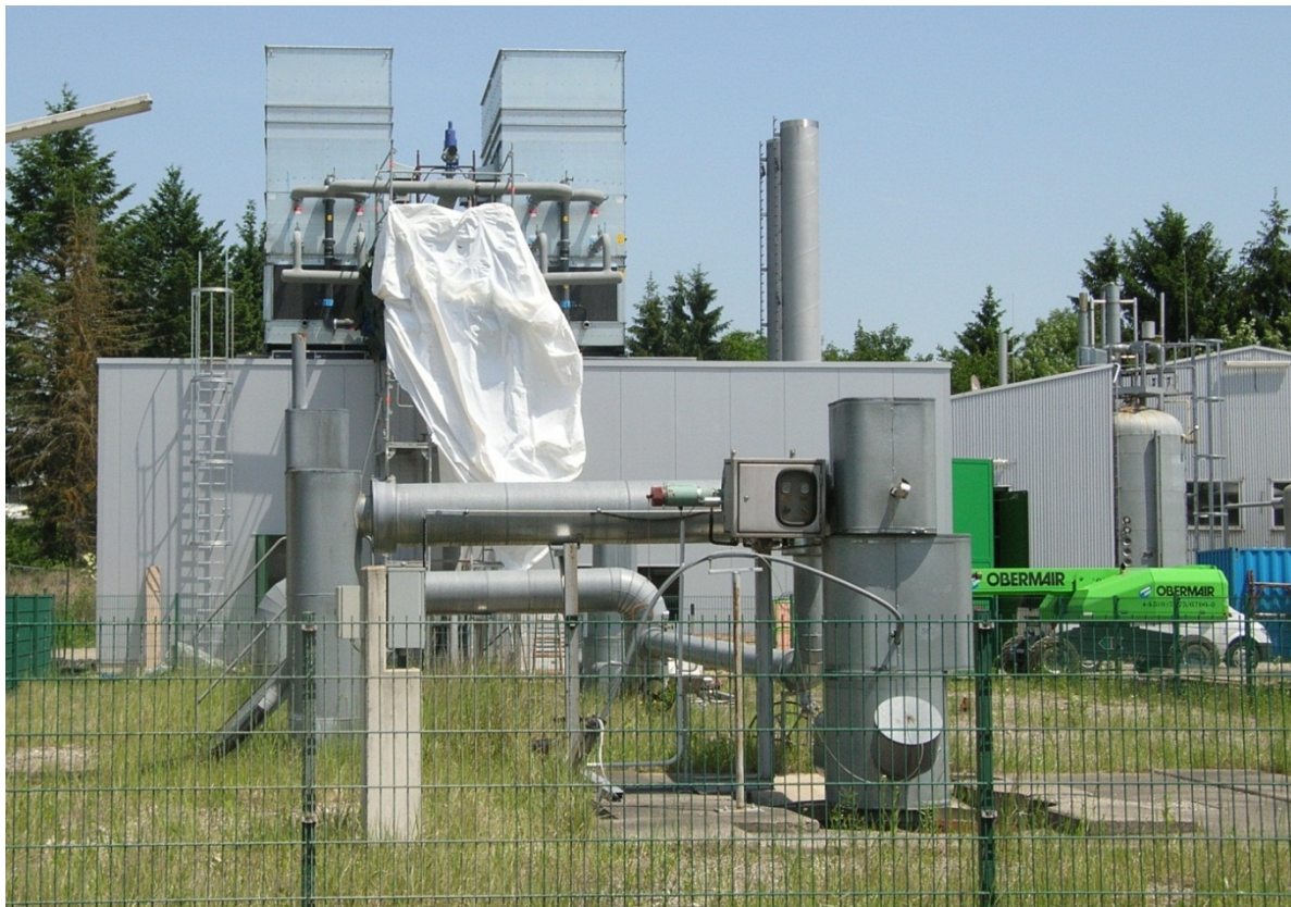
Abb.5: Dublette Simbach-Braunau: Reinjektionsbohrung, dahinter das Gebäude der ORC-Anlage mit Luftkühler am Dach; dahinter das Betriebsgebäude der Fernwärme
