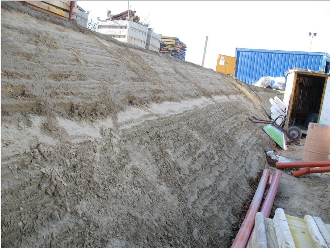
Abb. 2.1.3.6: Südwand des Bauplatzes in Schönering: Wellig abgelagerte, beige Schluffe („Schwemmlöss“) mit Feinsandlagen (Foto: Ch. Rupp).
