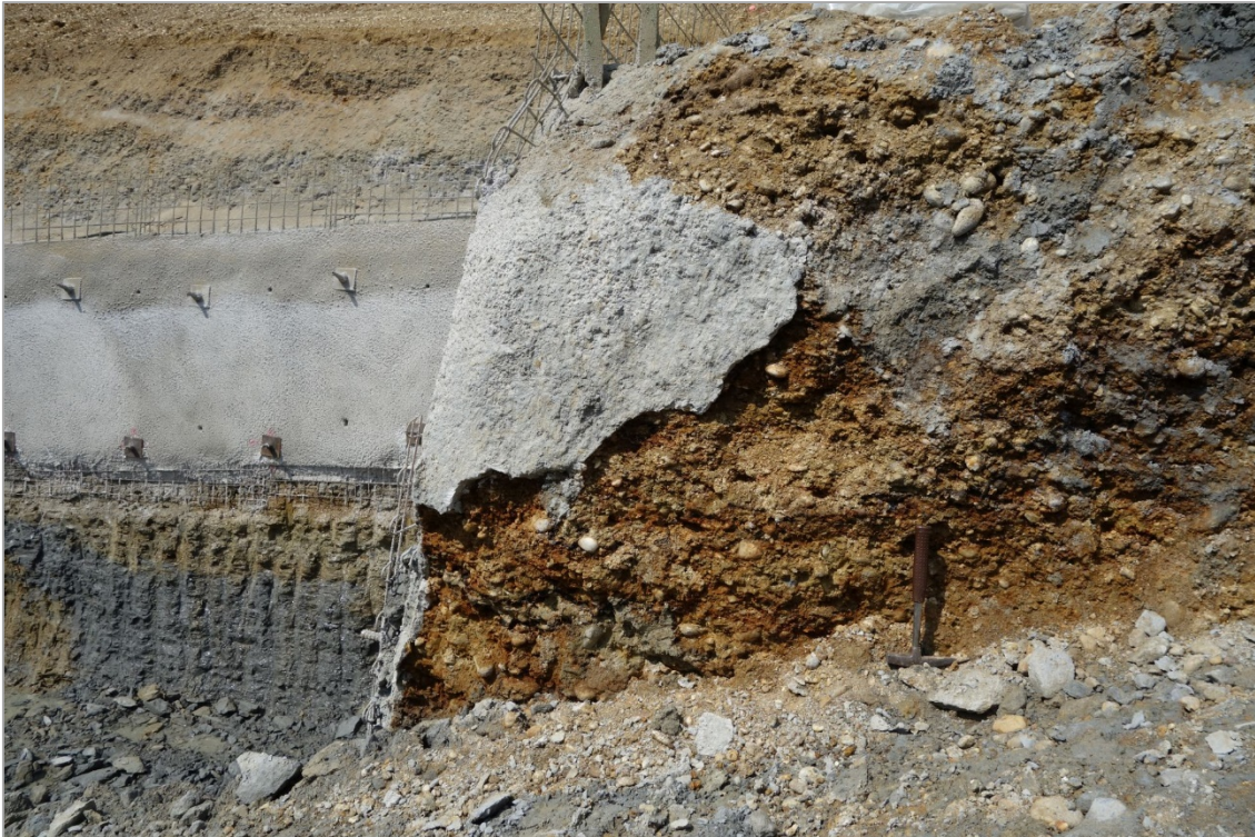
Abb. 2.1.2.42: Umfahrung Lambach-Nord- Aufschlusspunkt 3, Tunnelportal Ost: Übergang der quartären „Älteren Deckenschotter“ zur neogenen „Vöckla-Formation“ (Foto: H. Peresson).
