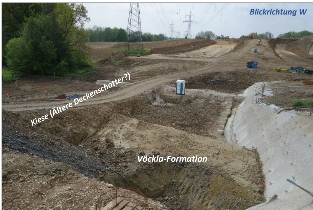
Abb. 2.1.2.26: Umfahrung Lambach-Nord- Aufschlusspunkt 2, Tunnelportal West: Baugrube in der zweiten Geländestufe mit „Älteren Deckenschottern“ an den Seitenwänden und Vöckla-Formation an der Basis (Foto: H. Peresson).
