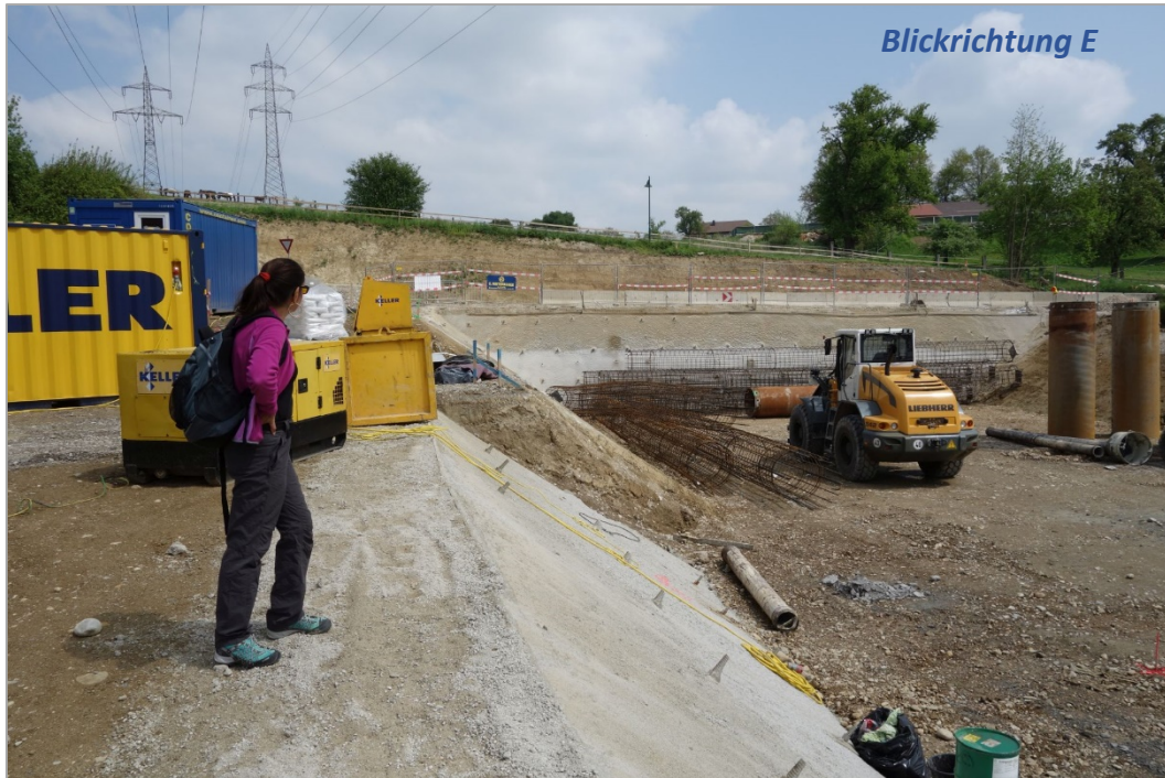
Abb. 2.1.2.23: Umfahrung Lambach-Nord- Aufschlusspunkt 2, Tunnelportal West: Überblick über den Aufschlussbereich an der ersten künstlichen Geländestufe; NE-Wände bereits fast zur Gänze ausbetoniert (Foto: H. Peresson).
