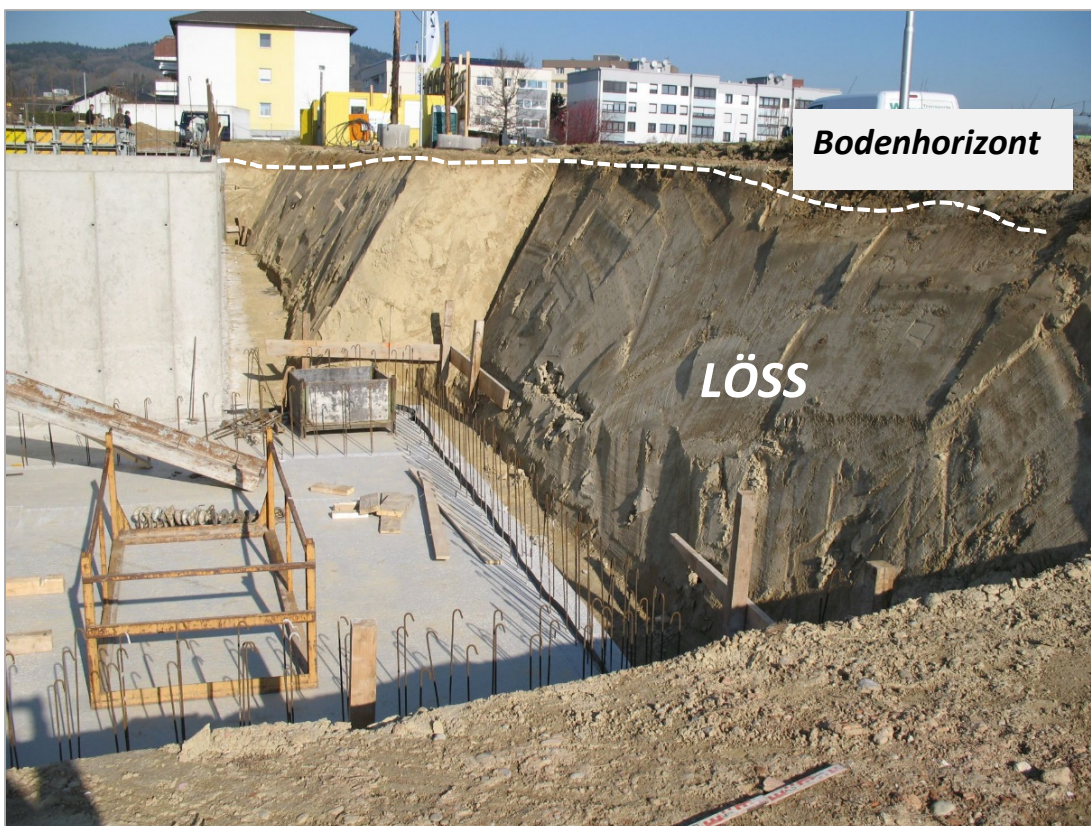
Abb. 2.1.4.6: Bauaushub im NE Bereich des Baustellengeländes in Leonding: Etwa 8 m tiefe Baugrube mit tonigen, strukturlosen Schluffen (Löss); im Hangenden ist ein Bodenhorizont erkennbar (Foto Ch. Rupp).
