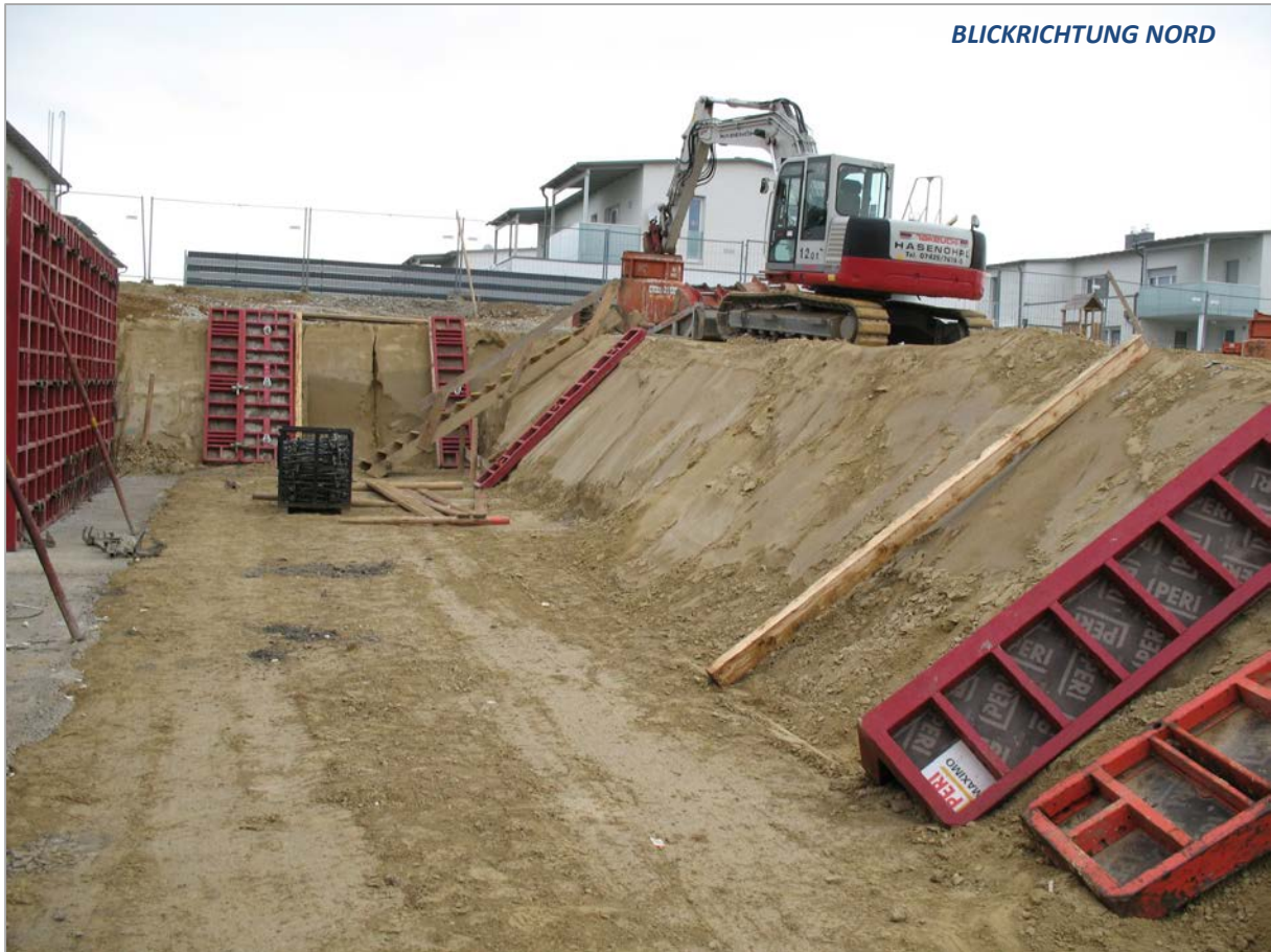
Abb. 2.1.4.16: Gelblichbrauner, schluffig toniger Löss in der Baugrube in Leonding (Stadtteil Haag) (Foto: Ch. Rupp).
