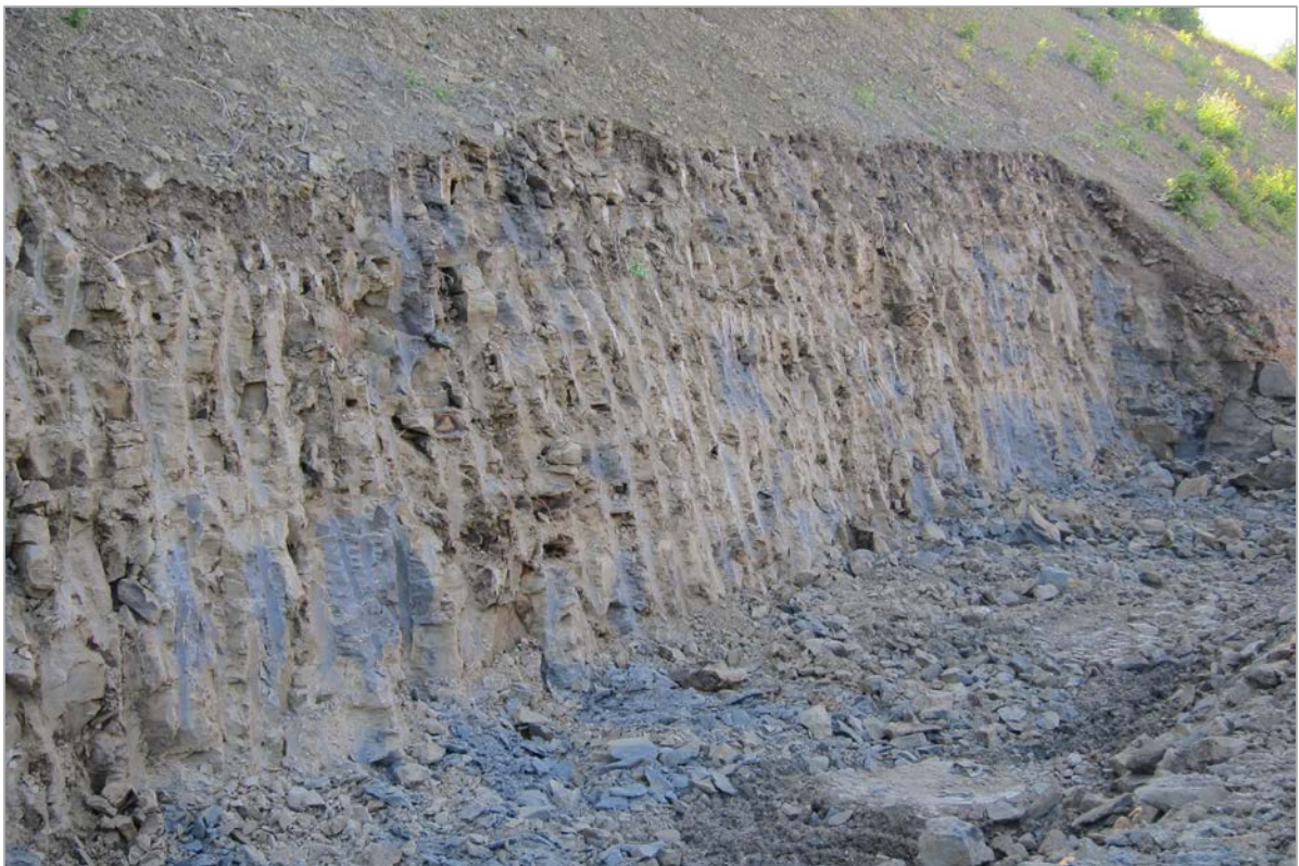
Abb. 2.1.1.35: Hanganschnitt an der A8 bei der Anschlussstelle Weibern: „Fleckig“ ausgebildete Otttang-Formation aufgrund unterschiedlicher Karbonatgehalte; an der Basis dickbankiger (thinning-upward) (Foto: M. Peresson).
