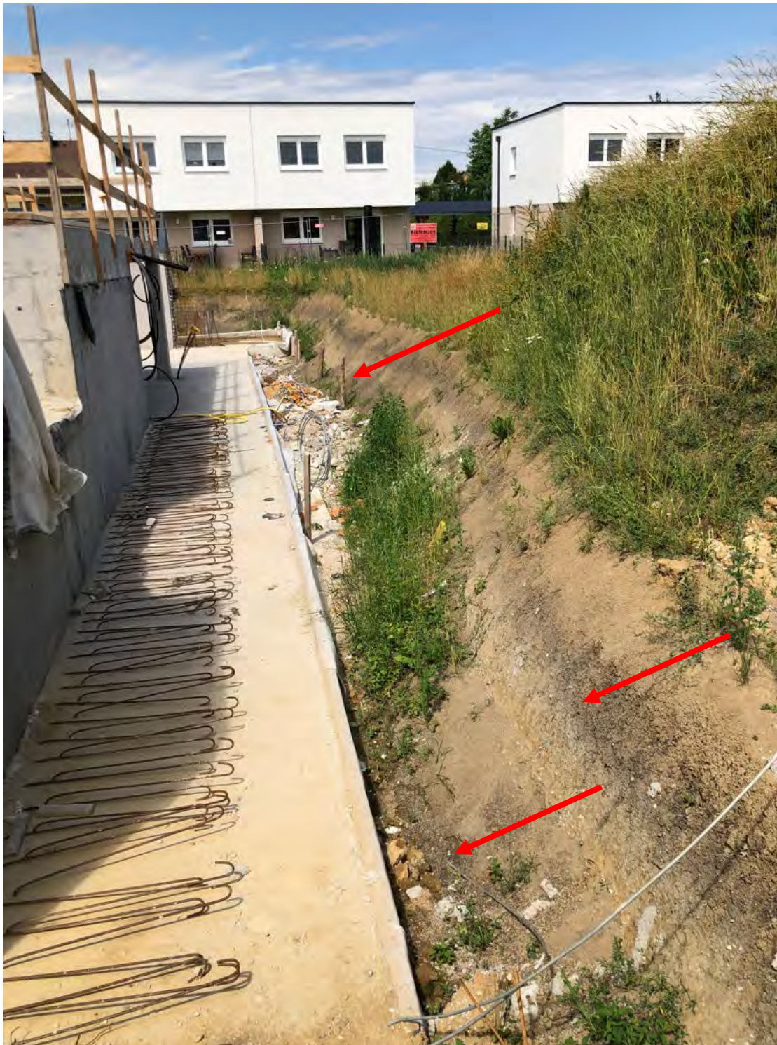
Abb. 2.2.2.8.: „Baulos Wohnhausanlage in Kematen an der Krems“: farbliche Zonierung im Hanganschnitt: die erste dunkelbraune Lage tritt ca. 25cm unterhalb der Geländeoberkante auf; die zweite dunkle Lage ist an der Basis des Hanganschnittes zu erkennen (Foto: M. Peresson).
