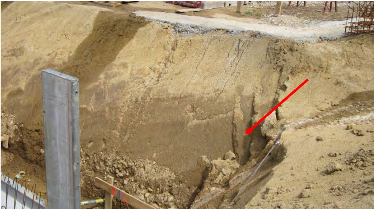
Abb. 2.3.2.12.: „Baulos Wohnhausanlage in Piberbach“: innerhalb der Lösslehme Rutschungs- (Sackungs)- Strukturen (Foto: M. Peresson).
