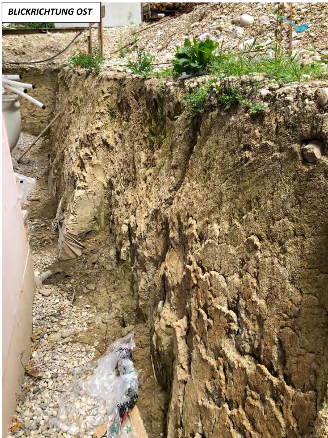
Abb. 2.3.1.8.: „Baulos Wohnhausanlage Neuhofen an der Krems“: Zwei Meter hohe Hangeschnitte rund um die Baustelle von tonig, sandigen braunen Schluffen (quartärer Lösslehm). Der gesamte Anschnitt ist völlig homogen ausgebildet und zeigt keine sedimentären Strukturen (Foto: M. Peresson).
