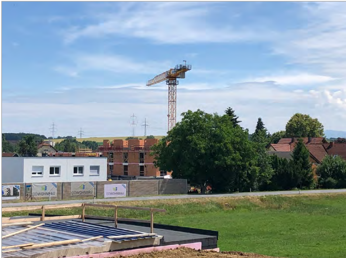
Abb. 2.2.2.6.: „Baulos Wohnhausanlage in Kematen an der Krems“: Überblick über den Baustellenbereich (Foto: M. Peresson).
