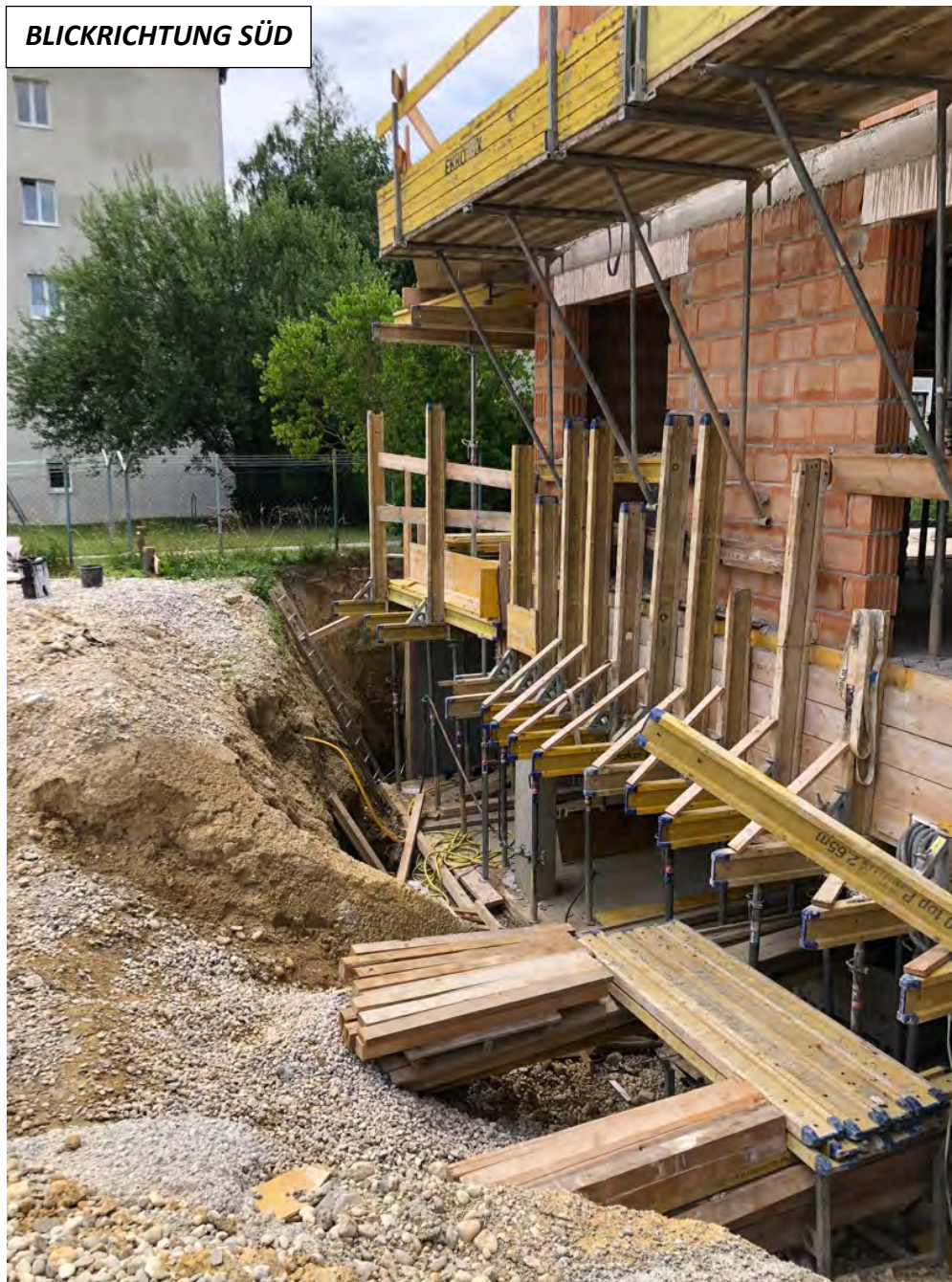
Abb. 2.3.1.7.: „Baulos Wohnhausanlage Neuhofen an der Krems“: Zwei Meter hohe Hanganschnitte rund um die Baustelle von tonig, sandigen Schluffen (quartärer Lösslehm) (Foto: M. Peresson).
