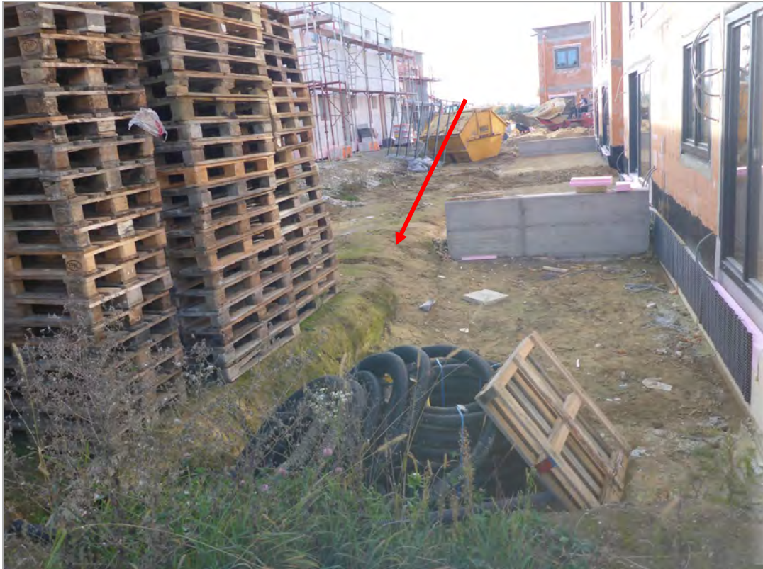
Abb. 2.3.3.10.: Bauplatz in Straßham: Im Bereich der Geländeoberkante tritt Löss im gesamten Baustellengelände auf (Foto: F. Hofmayer).
