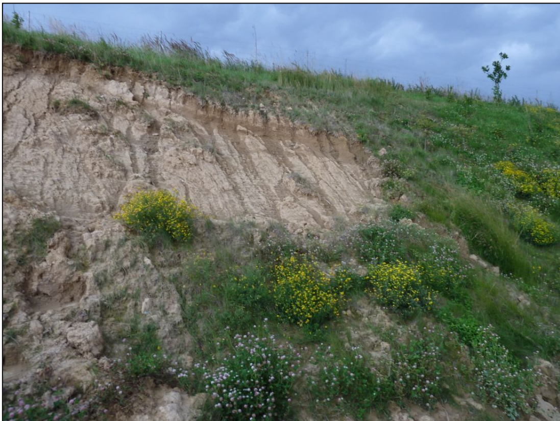
Abb. 2.2.1.36: Hangrutschung an bereits fertig gestelltem Baustellenabschnitt in der Atzbach-Formation; deutlich erkennbare Oberflächenerosion durch Wasserrinnen im sandigen Sediment (Foto: M. Peresson)
