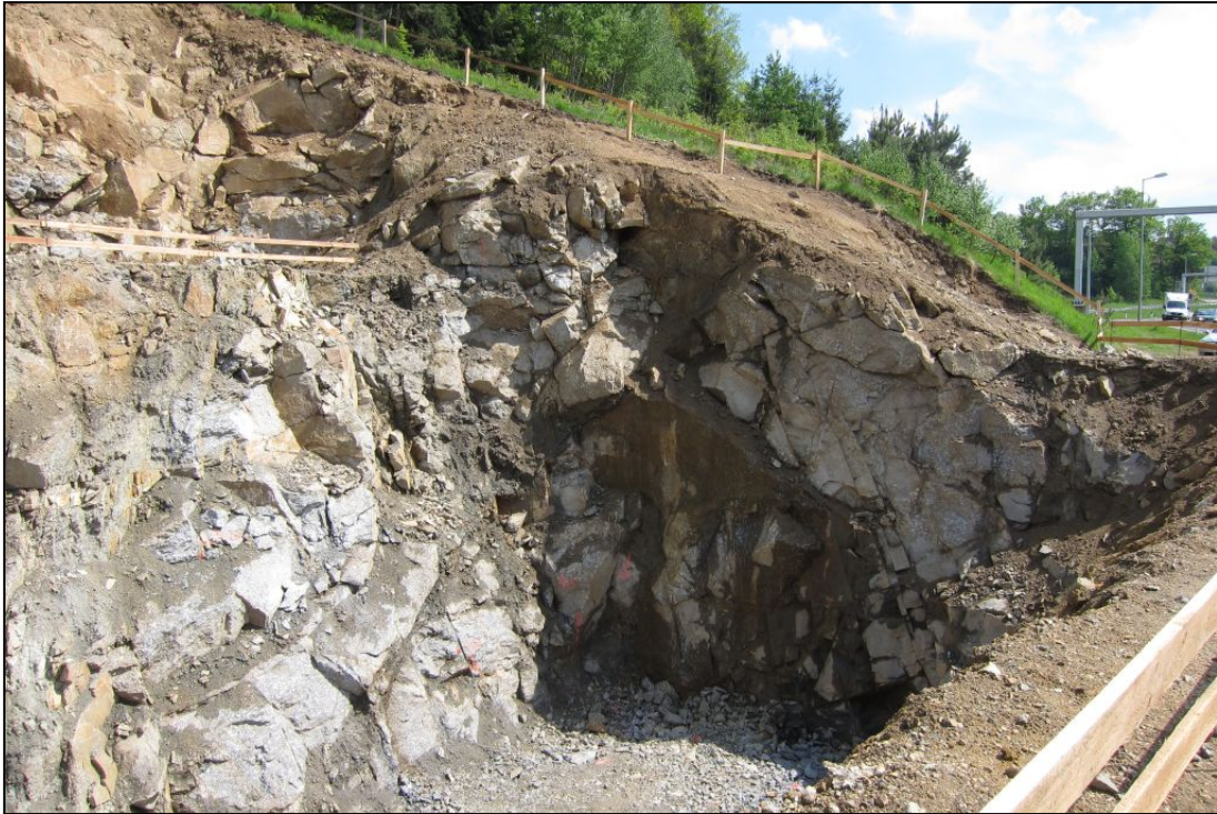
Abb. 2.1.1.11: Extrem tektonisierter Weinsberger Granit beim Nordportal des Tunnels Neumarkt (Foto: M. Peresson).
