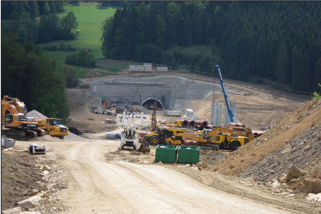
Abb. 2.1.1.4: Überblick über die Baustellentätigkeit im Nordportal des Tunnels Göttschka (Foto: M. Peresson).
