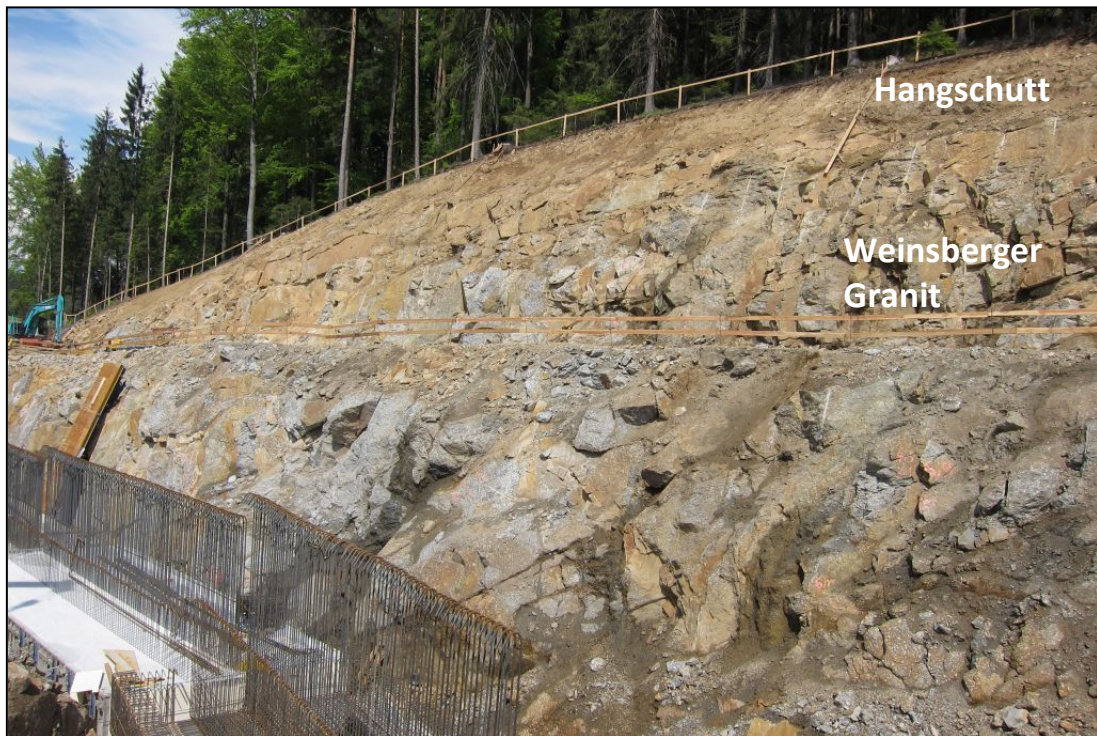
Abb. 2.1.1.10: Verwitterter und stark tektonisierter Weinsberger Granit beim Nordportal des Tunnels Neumarkt (Foto: M. Peresson).
