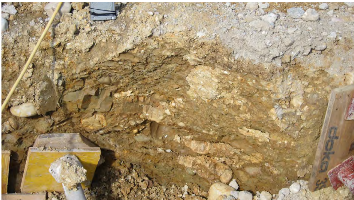
Abb. 2.1.1.16: Baustelle für eine Wohnhausanlage in Sierning: Detailaufnahme der Deckenschotter (Foto: M. Peresson).
