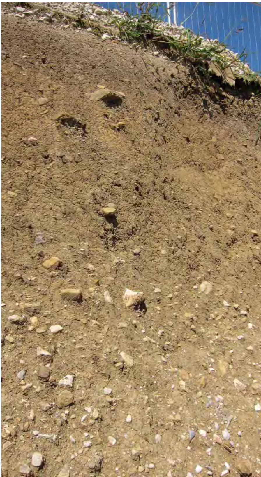
Abb. 2.2.3.27.: Baustelle „Wohnhausanlage in Kremsmünster“: Südseite des ersten Wohnhauskomplexes: Gemisch aus Kies, Steinen und Blöcken in sandig, schluffiger Matrix; wirkt komponentengestützt (Foto: M. Peresson).
