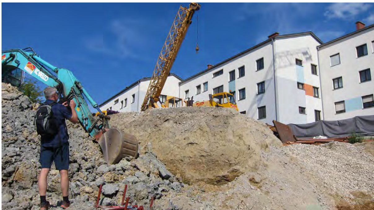
Abb. 2.1.1.9.: Baustelle für eine Wohnhausanlage in Sierning: ausgebaggerter dunkelgrauer Schluff (Robulusschlier) und im Hang anstehende quartäre Deckschicht (gelblicher Löss-Lehm) (Foto: M. Peresson).
