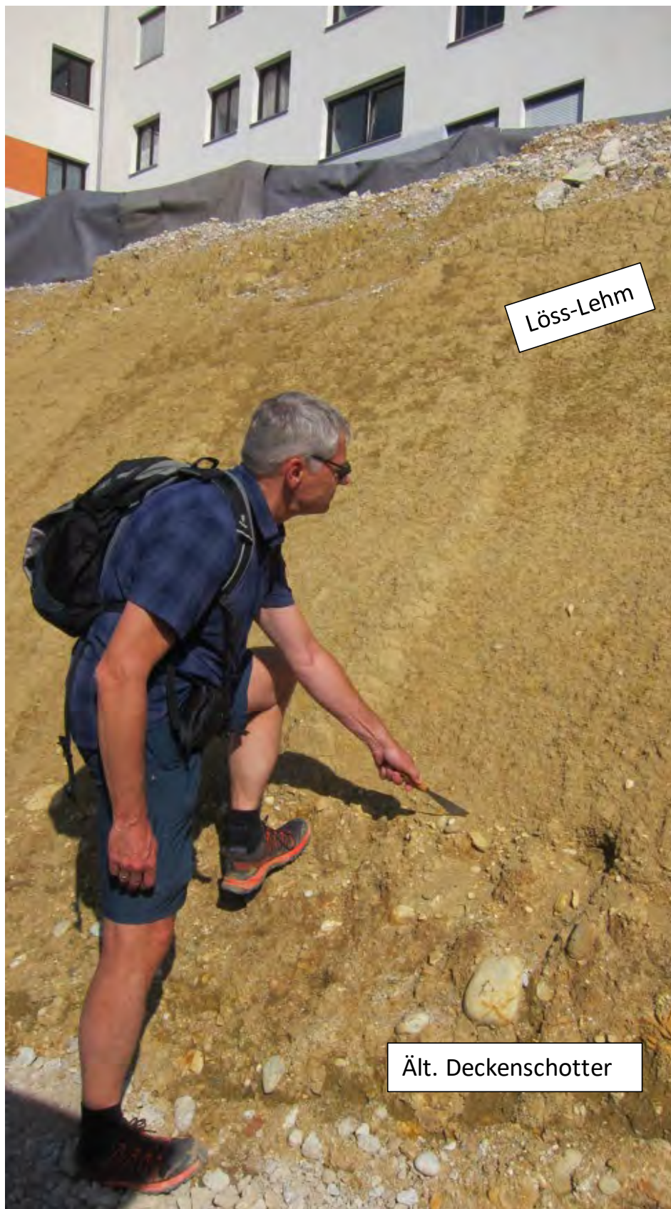
Abb. 2.1.1.11: Baustelle für eine Wohnhausanlage in Sierning: im Hangenden gelblicher Löss-Lehm mit Übergangsbereich zu Älteren Deckenschottern (stark verkittet und verfestigt mit Matrix); Grenze diffus ausgebildet (Foto: M. Peresson).
