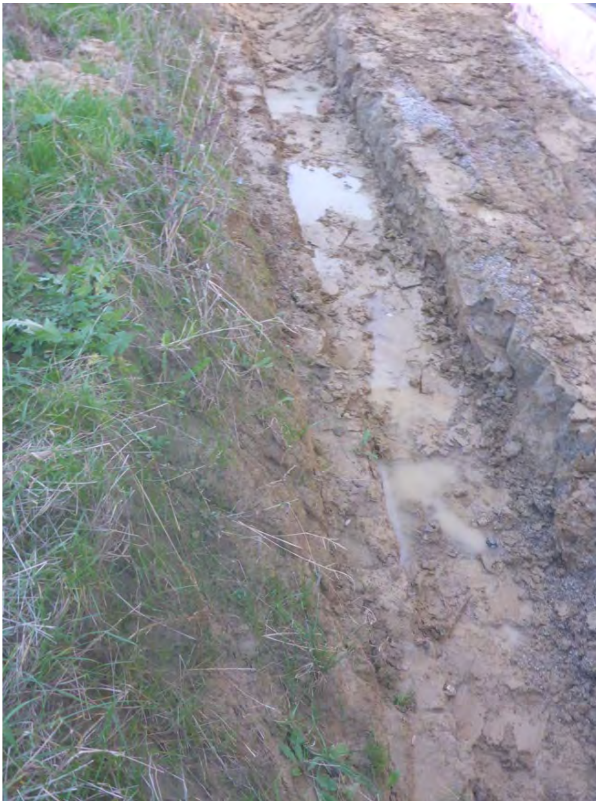
Abb. 2.1.4.9.: Baugrube in Niedergrafing: Im Bereich des anschließenden Ackerlandes an die Baustelle steht oberflächennahe verwitterter Robulus-Schlier an (Foto: F. Hofmayer).
