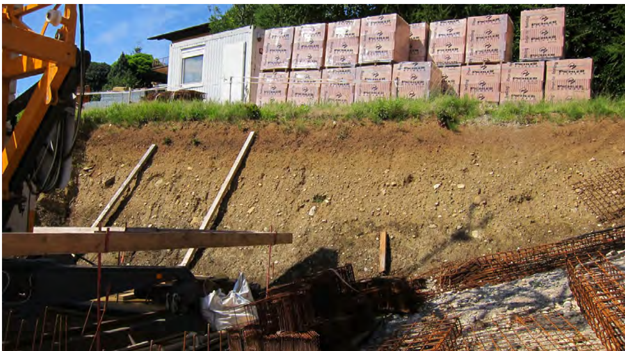
Abb. 2.2.3.29.: Baustelle „Wohnhausanlage in Kremsmünster“: Ostseite im hinteren Teil des Baugeländes Wohnhauskomplexes: am Top ein rötlicher Verlehmungshorizont; im hangenden Gemisch aus Kies, Steinen und Blöcken in sandig, schluffiger Matrix; (Foto: M. Peresson).
