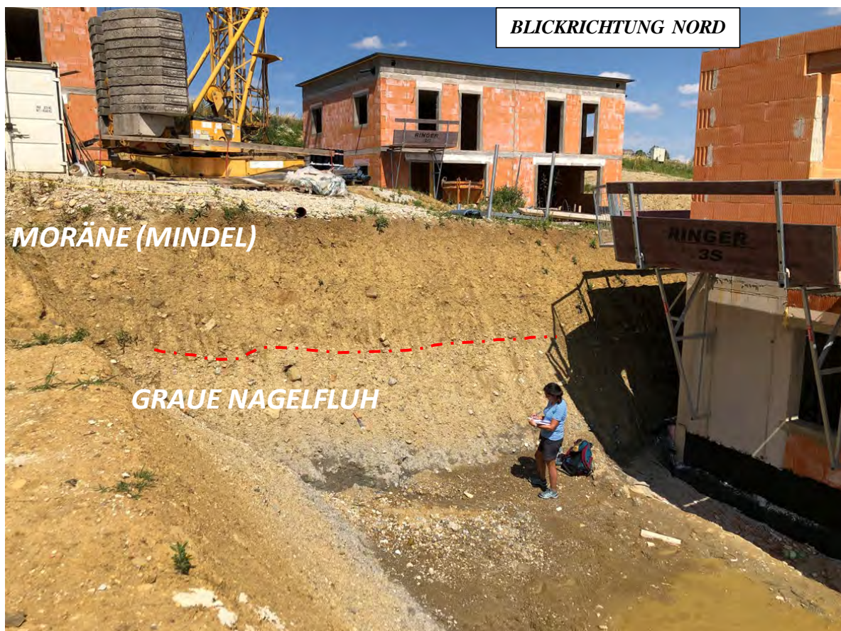
Abb. 2.2.3.13.: Baustelle „Reihenhaussiedlung in Kremsmünster: untere Etage; Moränenmaterial zeigt eine Zweigliederung aufgrund des Farb- und Materialunterschiedes (Foto: H. Peresson).
