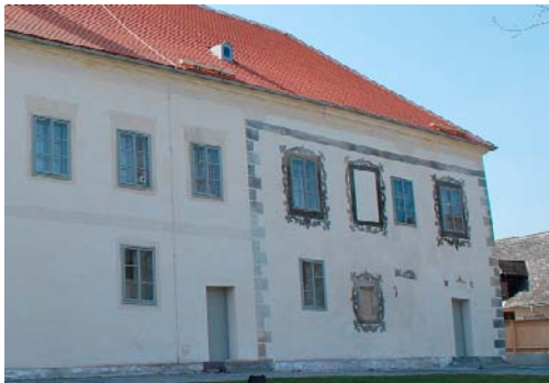
Nordfassade, westlicher Teil, vor Restaurierung (oben)
