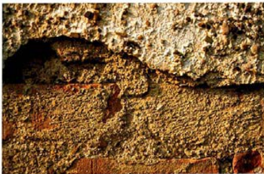
Leisdorf/Baden, NÖ, Gartenpavillon um 1700, Detail. Quaderung mit farblich unterschiedlichem Fugenritz und in Schablonen geworfenem Riesel
