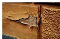
Hygroskopische Feuchtigkeit (außer bei neu vermauertem Fenster)
