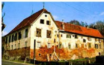
Langzeitverhalten des Versuchs einer Sanierung nur mit Sanierputz: Zustand 1979 vorher
