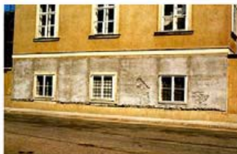
Sanierputze sollen mit horizontalem Fassadenelement abschließen
