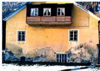
Bei Beibehaltung der Erdgeschoßnutzung keine Intervention nötig
