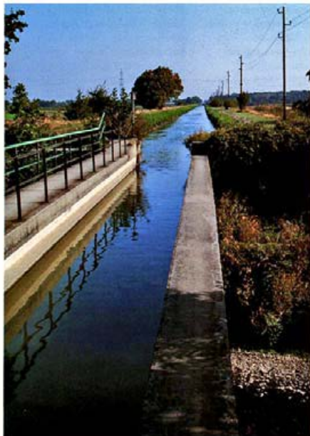
Bei jenen Objekten, die der Überquerung von Wasserläufen dienen, wurden die ursprünglichen Holztröge, so wie hier hinter Schönau, durch Betontröge ersetzt.
