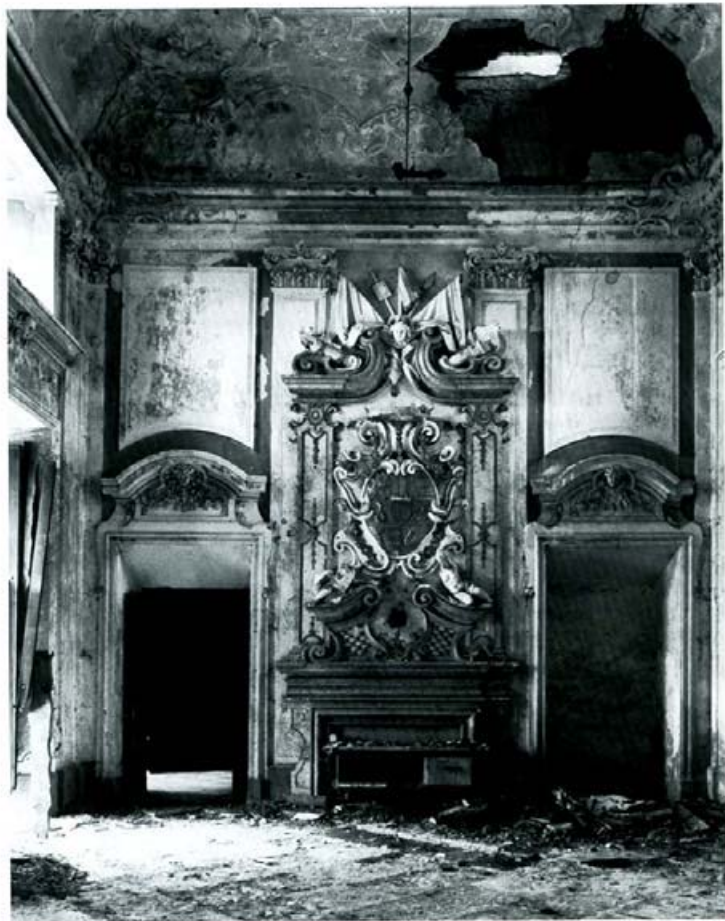
Der Hauptsaal im Schloß Ladendorf, dessen Decke heute auch bereits gepölzt ist
