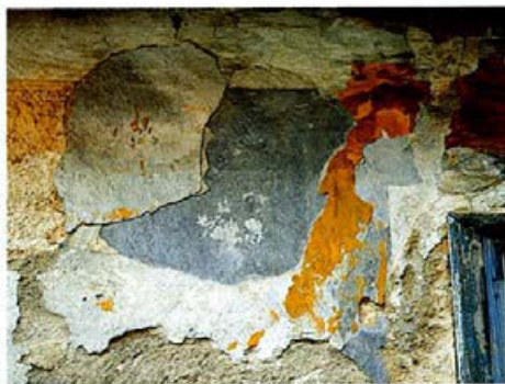
Unzählige Geschichten könnte dieses Stück Putz mit Kalkfarbe erzählen.
