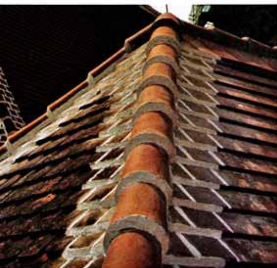
Ostrakt — alte Deckung und neue Kappen
