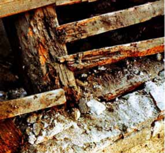
Kreuzgang, Westtrakt, Schadensbild
