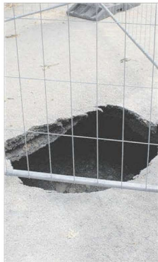
Derzeit ist der Kröpfelsteig unweit des SOS-Kinderdorfes abgesperrt, ein Loch tut sich auf. Foto: Schätzle
