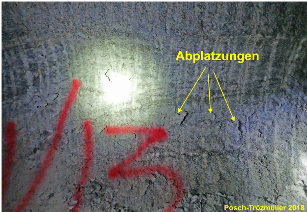
Abb. 2/195: Lokalität P01/13 auf Sohle 7 des Gipsbergbaues Preinsfeld. Abplatzungen vom Gips der Stollenwand, wie sie mit den gelben Pfeilen gekennzeichnet sind, wurden als Probe 1 entnommen.
