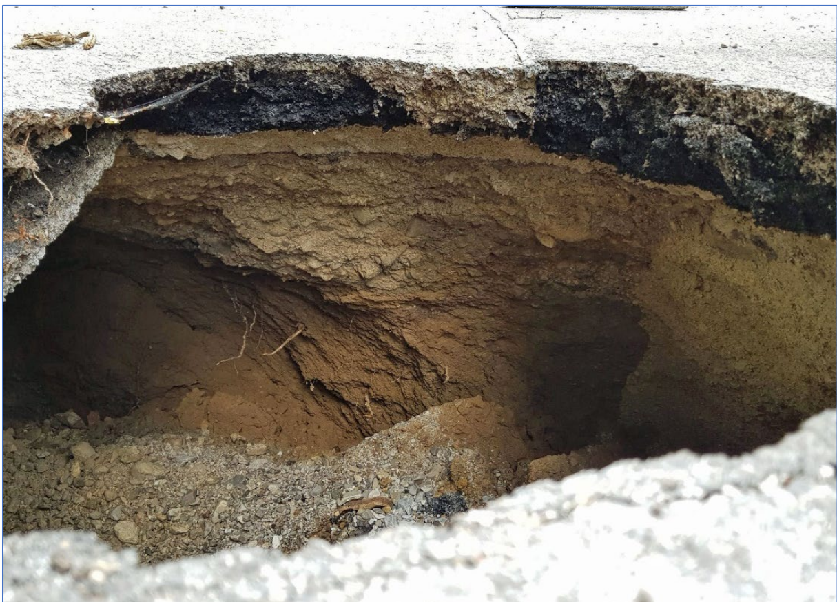
Abb. 2/230: Blick in den Erdfall in der Kröpfelsteigstraße in Hinterbrühl (Foto: G. Posch-Trözmüller, 21.5.2018).
