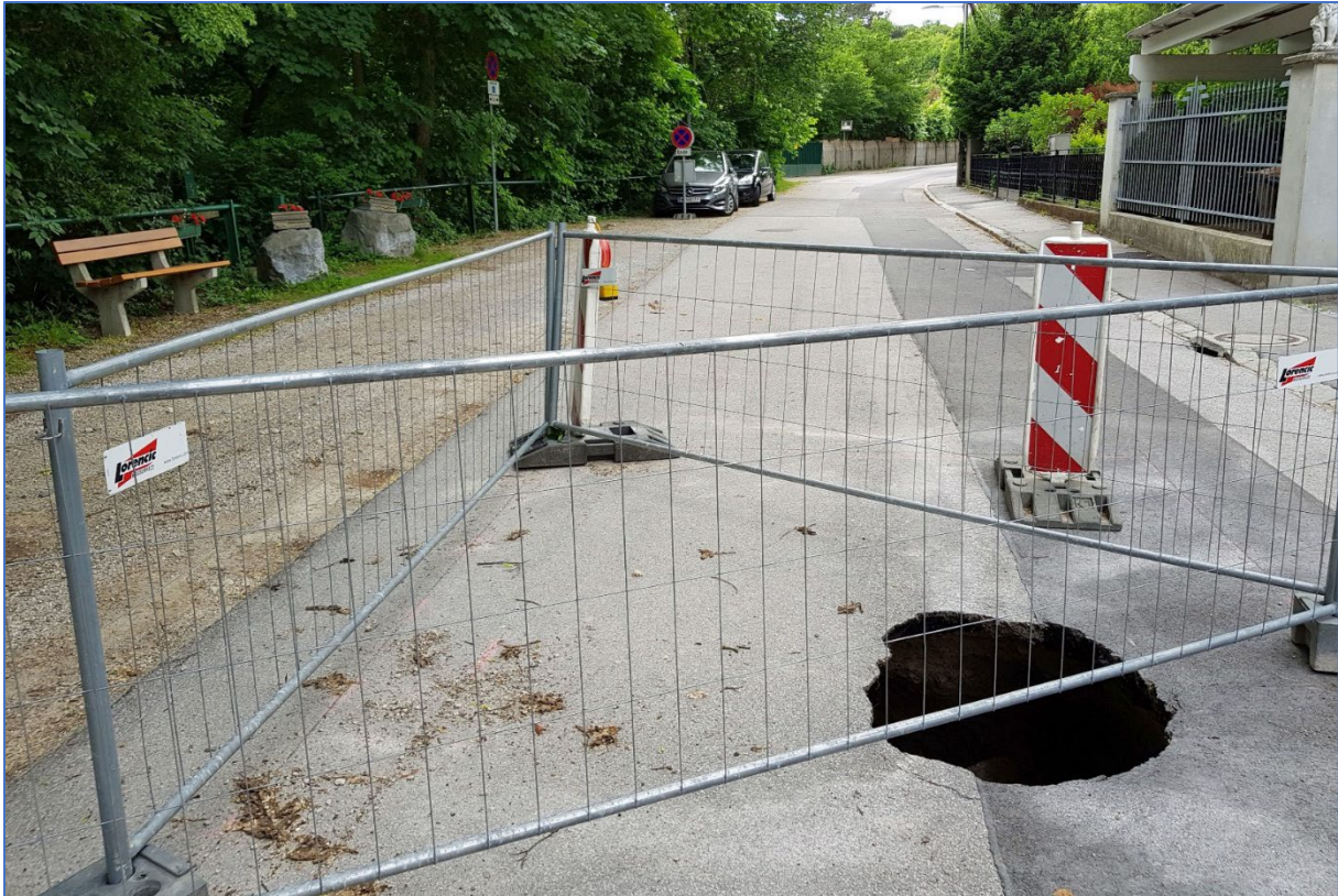
Abb. 2/229: Erdfall in der Kröpfelsteigstraße in Hinterbrühl (Foto: G. Posch-Trözmüller, 21.5.2018).
