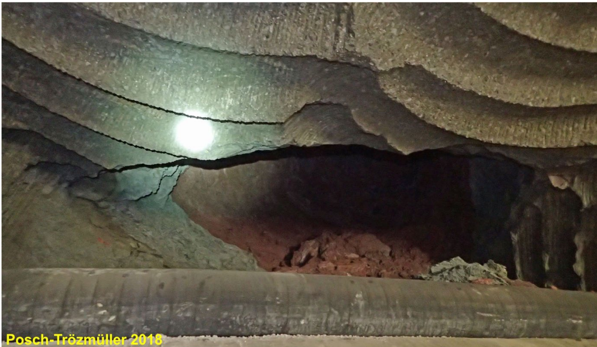
Abb. 2/182: Verbruch in Werfen-Fm. (rotbraun) auf Sohle 7. Hier wurde bis in die überlagernden Werfener Schichten vorgetrieben, was zu Instabilität führte.
