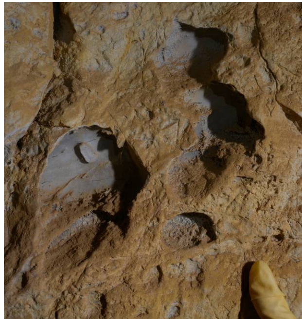
Abb. 6.-11: Typische replacement pockets, wo Kalk durch schwefelsäurehaltiges Kondensat in Gips umgewandelt wurde. Der Gips wurde später weggelöst. Handschuhfinger (rechts unten) als Größenvergleich.
